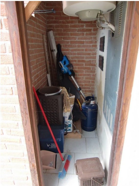
Vano caldaia con bollitore acqua e predisposizione per installazione caldaia a gas
