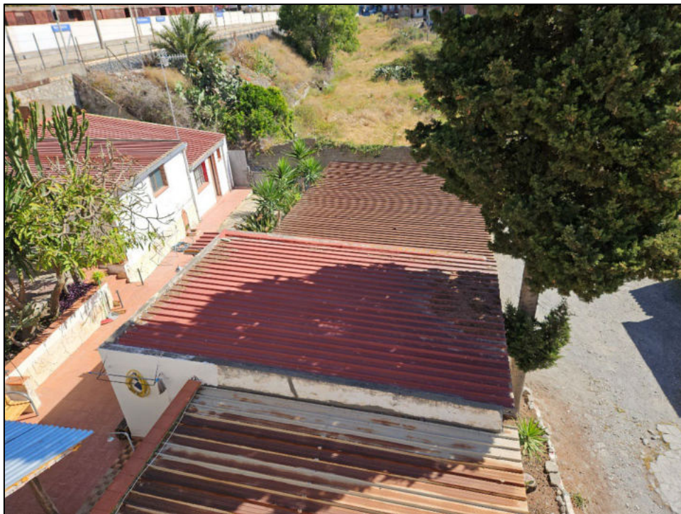
Foto 22: vista copertura manufatti abusivi.
