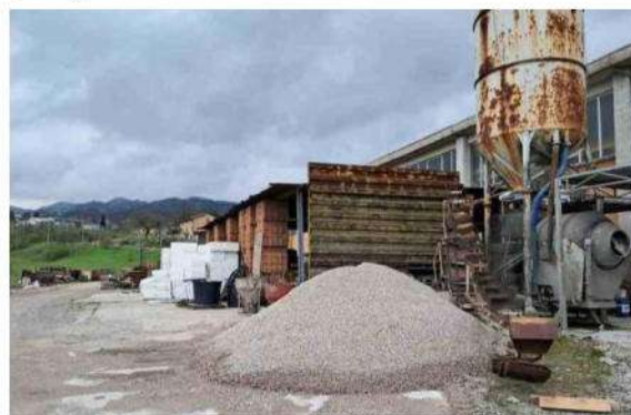
Figura 21: esterno 4D Prospetto Est - con accrescimenti non regolamentati
