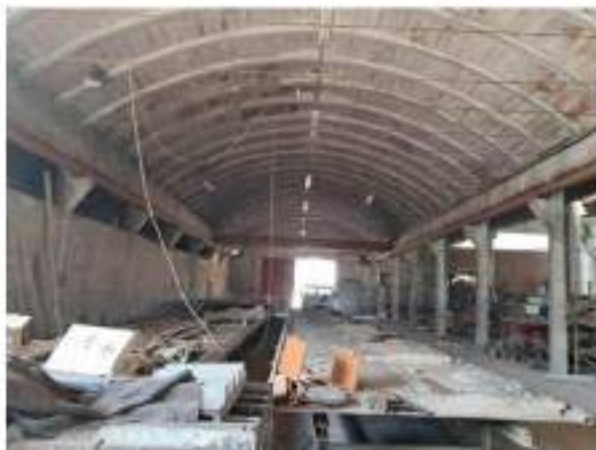
Figura 75: interno 1B - Vista interna del capannone di primo impianto (ove sono presenti infiltrazioni d'acqua)
