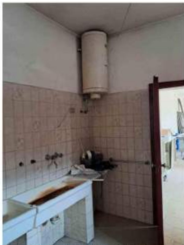
Figura 83: interno 9B - presenza di scaldacqua vetusto da rimuovere
