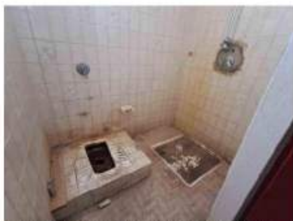
Figura 81: interno 7B - bagno con doccia
