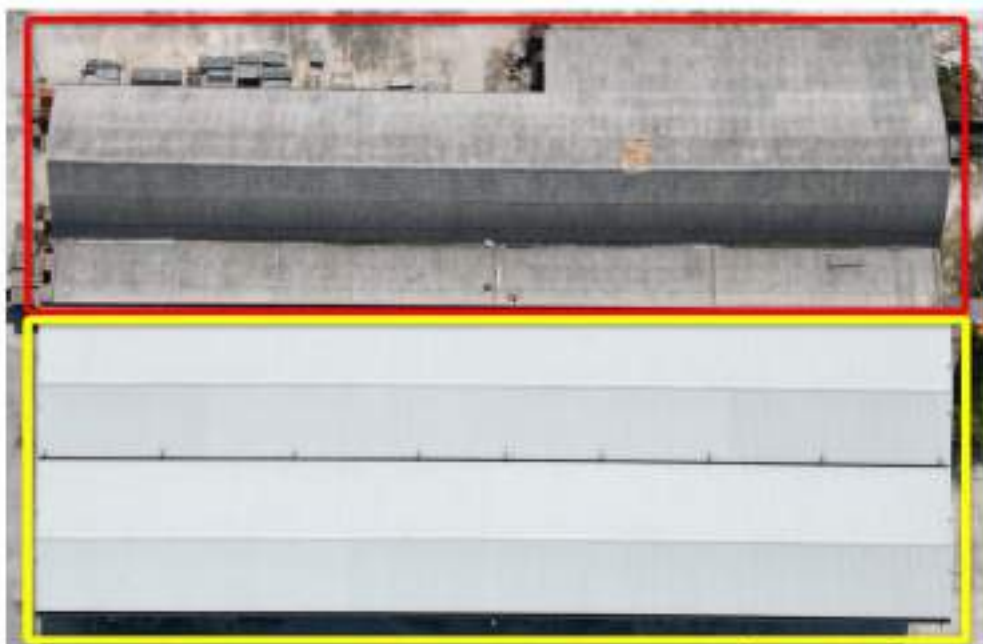
Figura 64: Esterno 1B - la copertura riquadrata in rosso è quella in onduline in fibrocemento, ove alcune lastre si sono distaccate e vi sono problemi d'infiltrazione d'acqua, mentre l'area riquadrata in giallo, corrisponde ai capannoni in cui è stato inserito piastrame antisismico, rifatta la copertura con posa di linea vita
