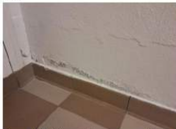
Figura 98: Interno 6 C - presenza di umidità da risalita
