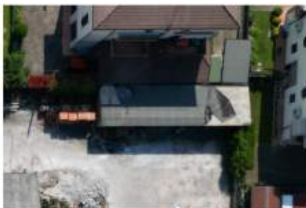
Figura 73: esterno 10B - vista aerea dove si evince il distacco della guaina
