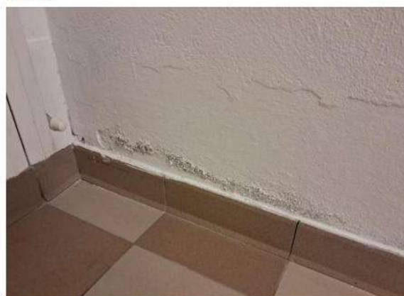
Figura 30: Interno 6 C - presenza di umidità da risalita
