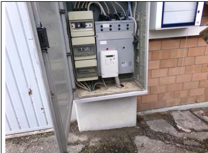
Piano terra quadri elettrici
