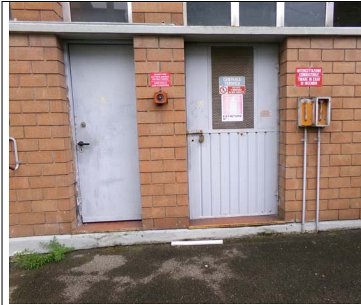
Piano terra locale caldaia
