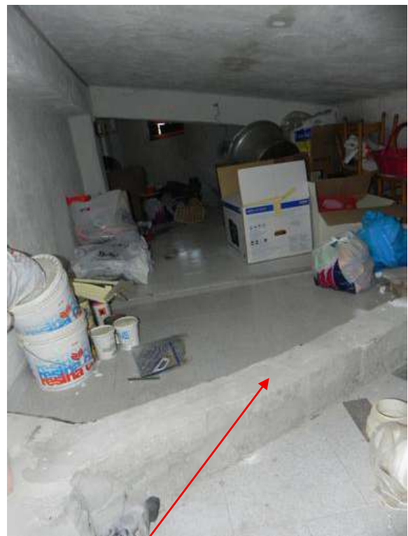
condotta a servizio dell'appartamento di proprietà di terzi
