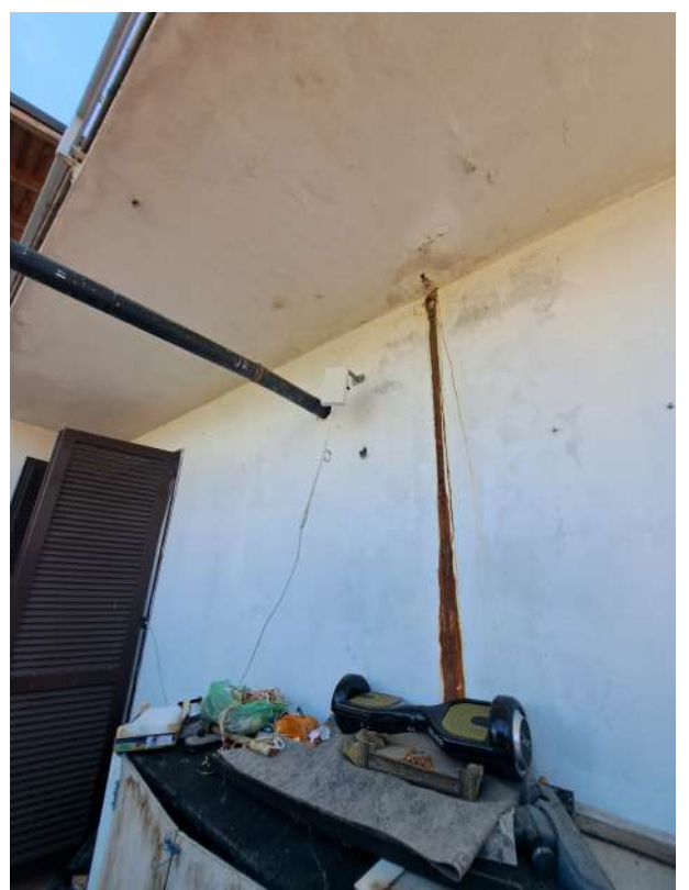
Figura 7- facciata ovest - infiltrazioni
