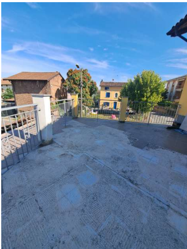
Figura 37- pavimentazione terrazzo - non integra
