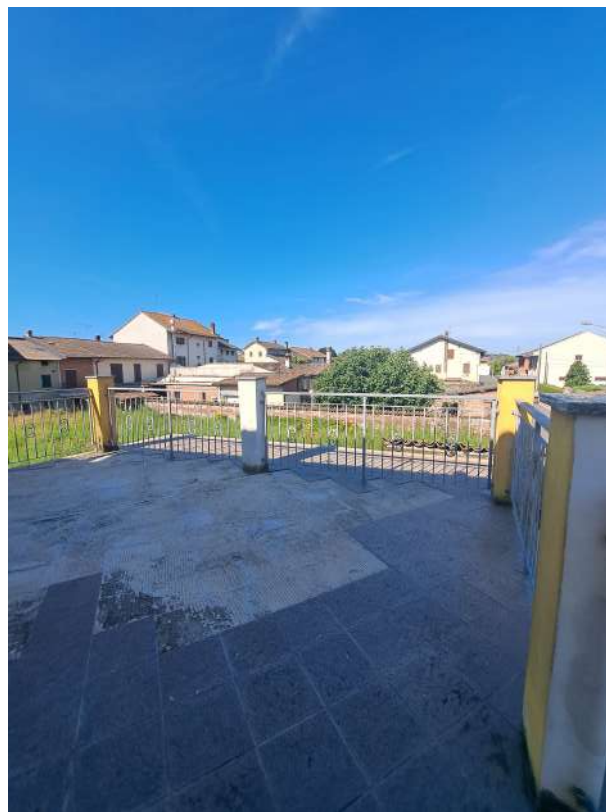
Figura 38- pavimentazione terrazzo - non integra
