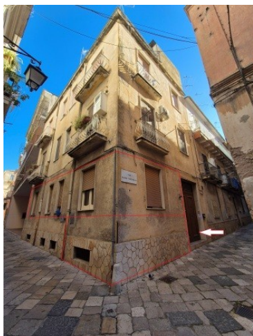
Figura 3 fabbricato a cui appartiene l'appartamento pignorato con accesso al vico Flavio Ventriglia n.15 in Capua
