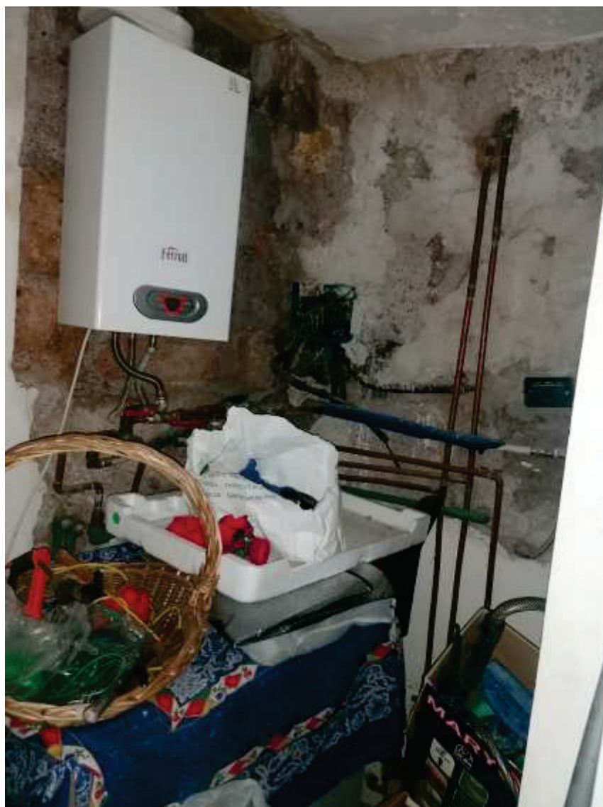
Foto N°18 Vano tecnico realizzato nell'ampliamento ( in assenza di titolo abilitativo)
