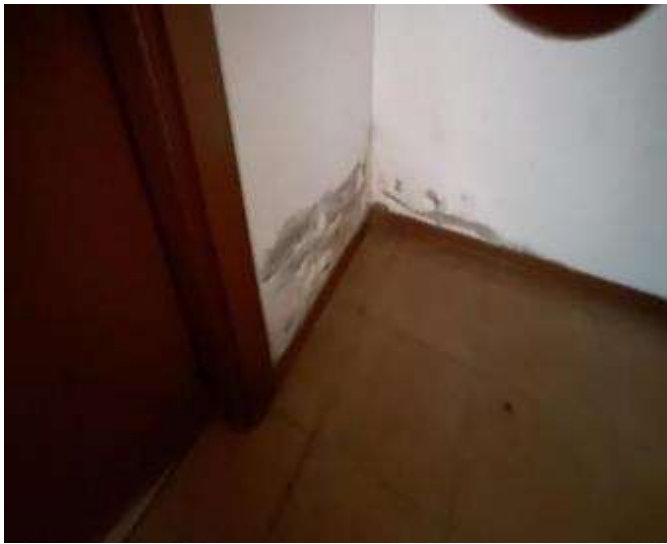
Interno 3 -Disimpegno (infiltrazioni)
