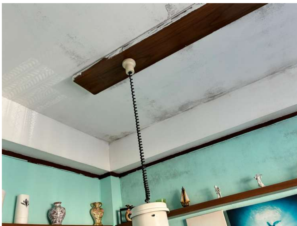
Vista interna punti di umido soffitto
