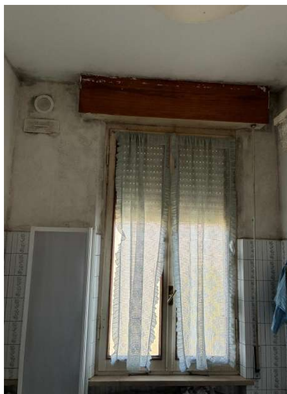
Vista interna bagno con umido e muffe
