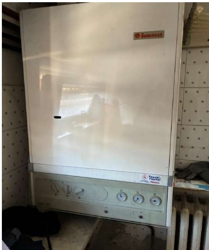
Vista interna caldaia
