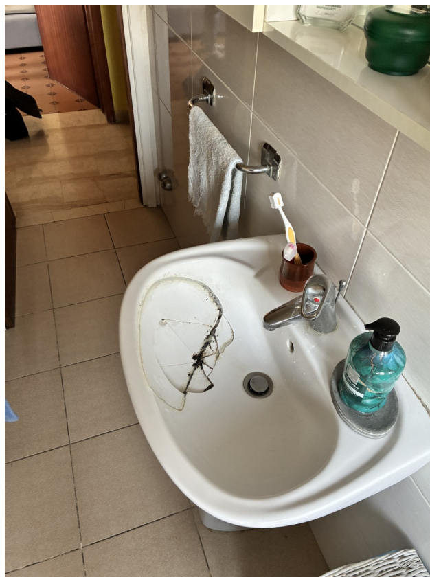
Vista interna lavabo bagno danneggiato
