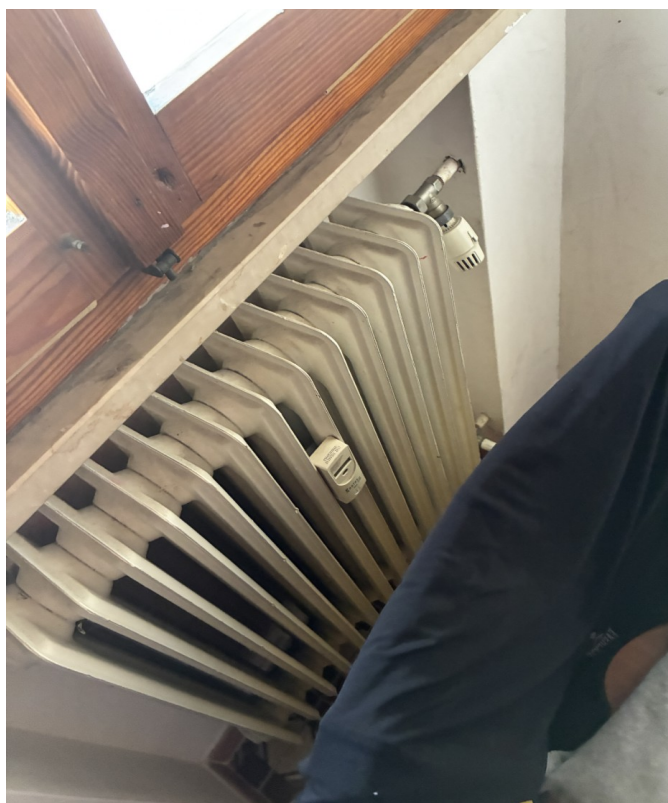
Vista interna termosifone
