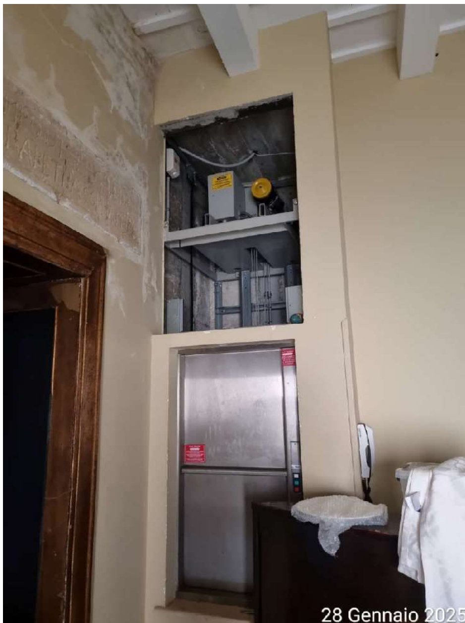
Complesso immobiliare, Piano Primo (montacarichi e montavivande)
