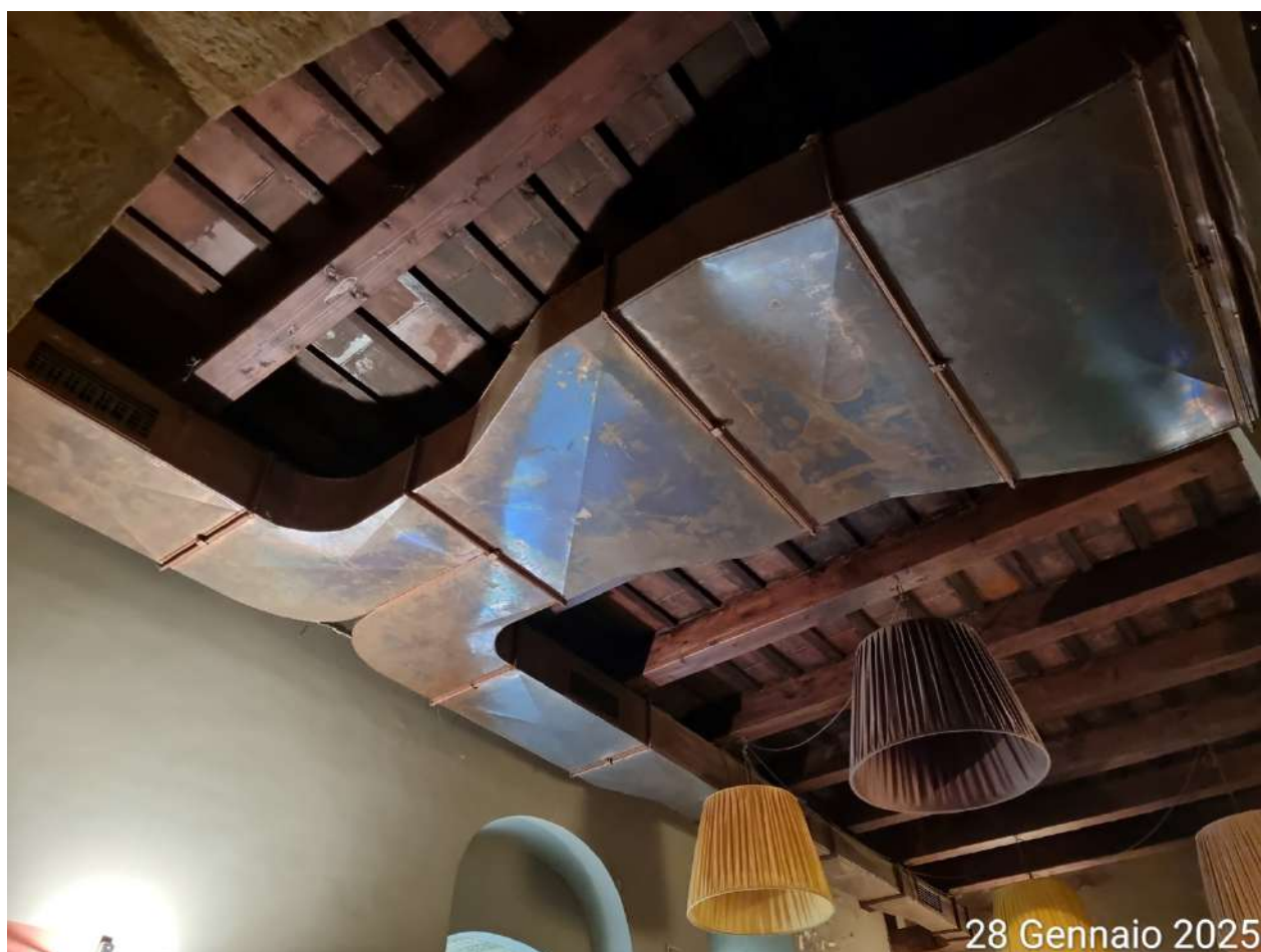
Complesso immobiliare, Piano Terra (particolare tetto in legno e impianto climatizzazione)
