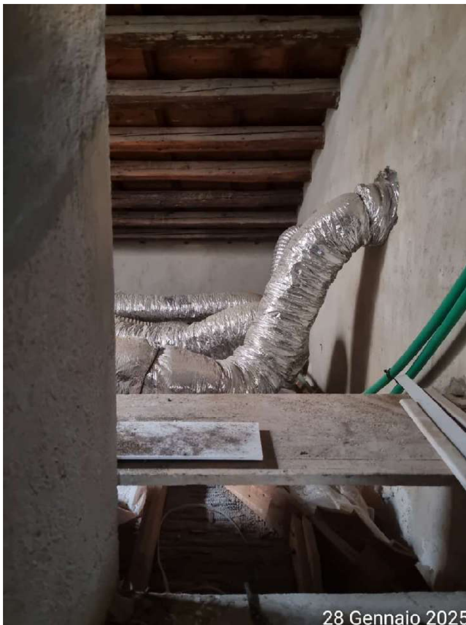
Complesso immobiliare, Piano Secondo (tubazioni impianto climatizzazione)
