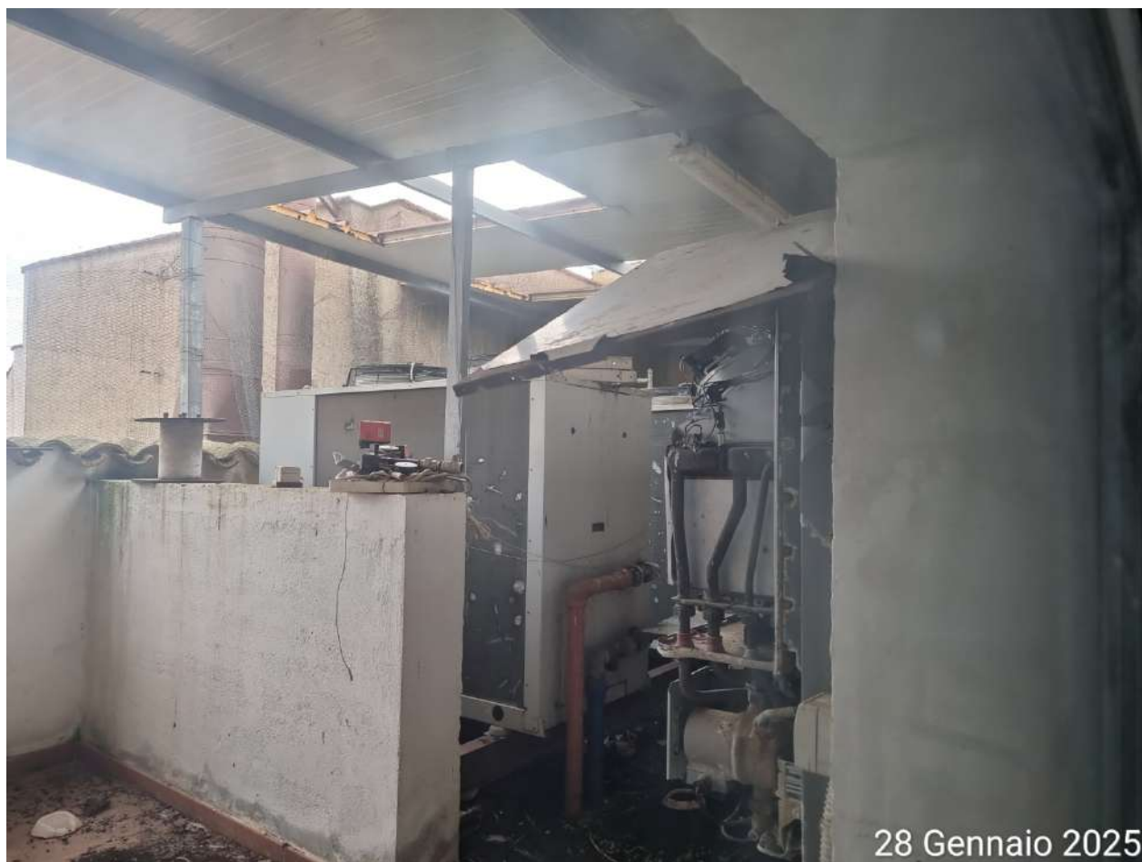
Complesso immobiliare, Piano Secondo (macchine climatizzazione nel terrazzo)
