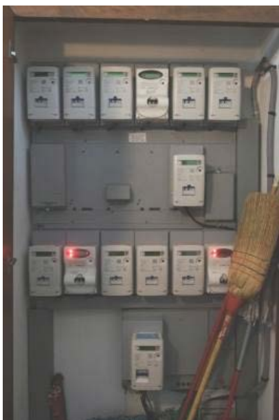
foto n.99 – particolare della nicchia dei contatori dell'energia elettrica, ubicata a destra della porta di ingresso al fabbricato dal civico 18 di via Chiaramonti, di cui al sub.38 dell'e.p.
