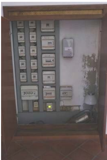
foto n.101 – veduta della nicchia con quadri elettrici, ubicata in fondo al corridoio di ingresso al fabbricato dal civico 18 di via Chiaramonti, di cui al sub.38 dell'e.p.
