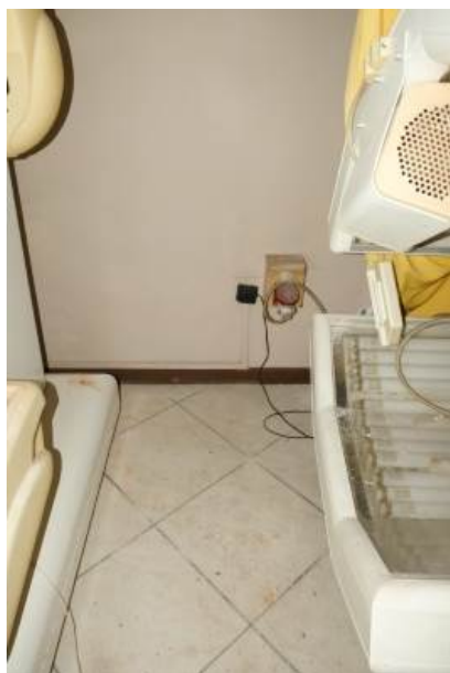
foto n.90-91 – particolari delle finiture dell'impianto elettrico al piano primo sottostrada
