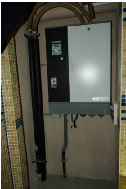
foto n.57 – veduta della “caldaia” ubicata al piano primo sottostrada presumibilmente per il funzionamento del bagno turco
