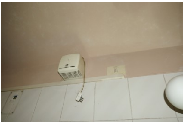
foto n.96 – particolare dell'impianto di aspirazione forzata dei bagni esistenti al piano primo sottostrada
