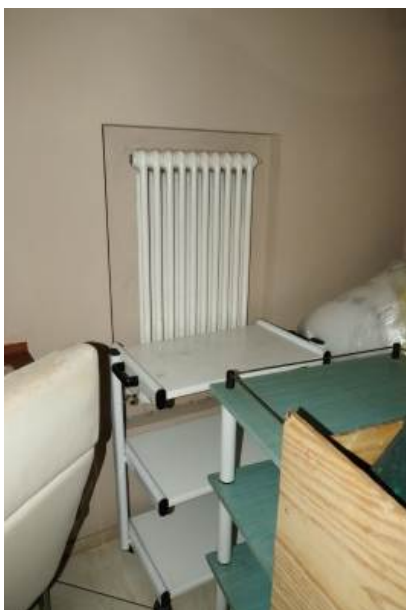
foto n.85 – particolare dei corpi scaldanti ubicati al piano terra e primo sottostrada
