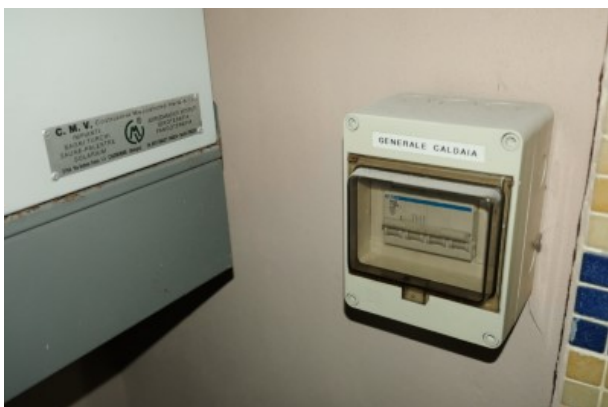
foto n.95 – particolare dell'interruttore della "caldaia" installata al piano primo sottostrada
