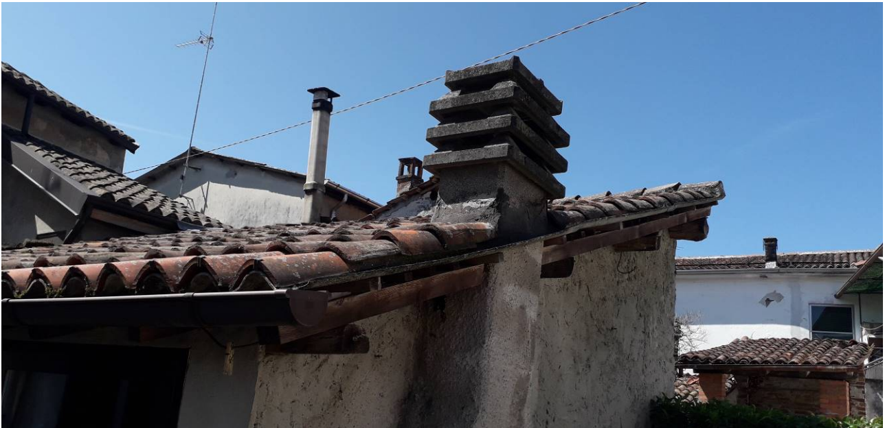
Particolare tetto locale accessorio con Eternit da rimuovere
