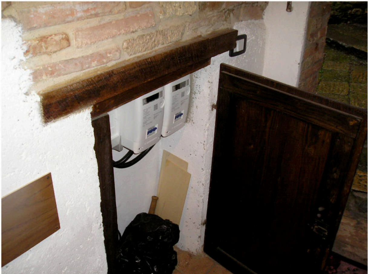
Fotografia 18 - Utenze Luce Sub.41-42 (Interne a Corridoio Comune)
