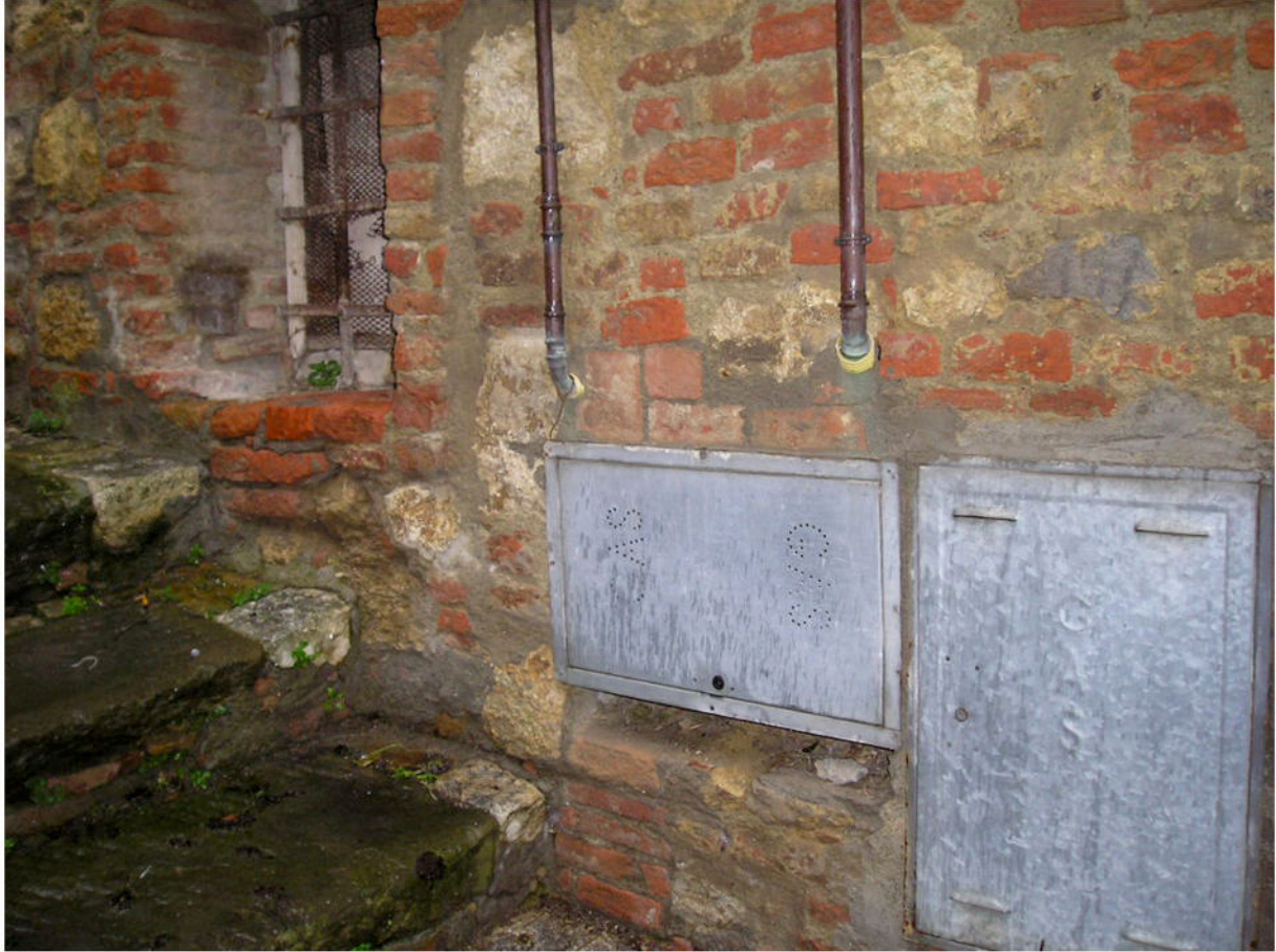
Fotografia 15 - Sportelli Utenze Gas (Sub.18 e Sub.41-42)
