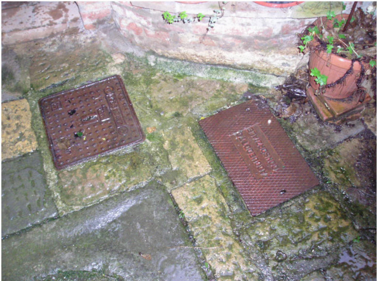
Fotografia 16 - Pozzetti Utenze Acquedotto (Sub.18 e Sub.41-42)
