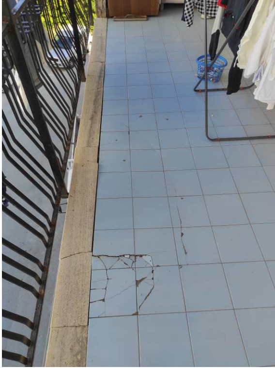
Foto 21 - balcone 2, pessime condizioni di manutenzione
