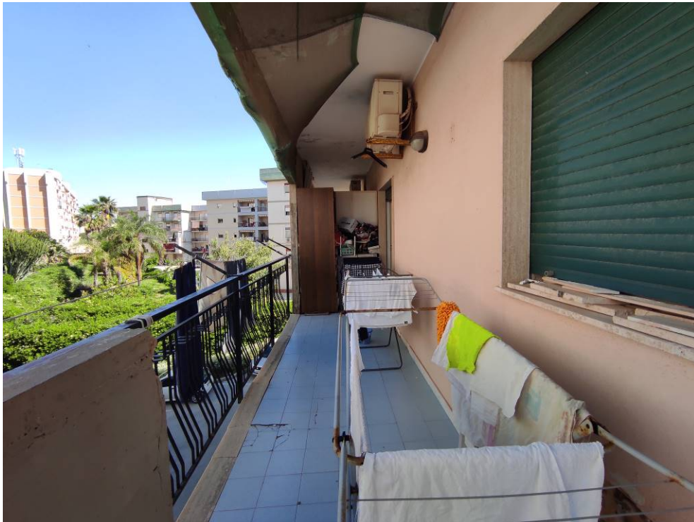
Foto 19 – balcone 2, pessime condizioni di manutenzione
