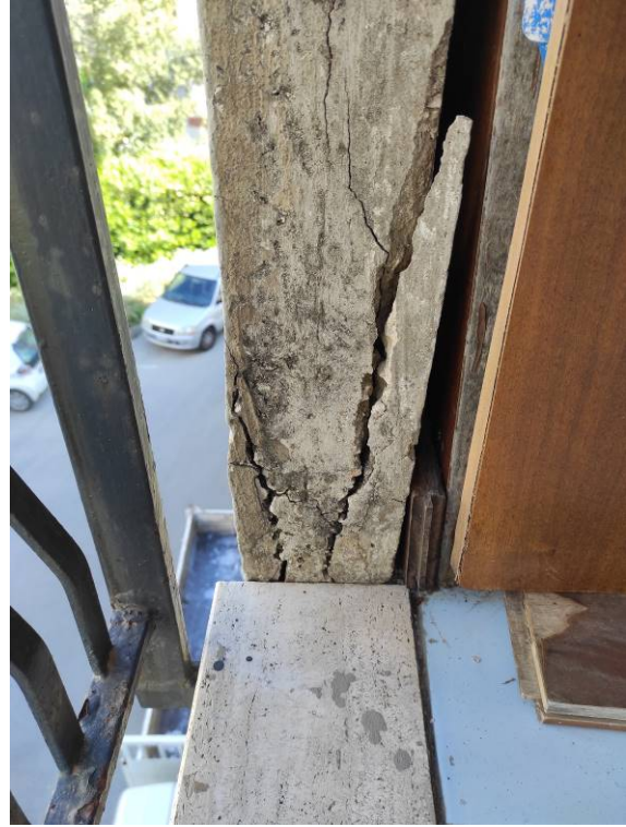
Foto 22 - balcone 2, pessime condizioni di manutenzione
