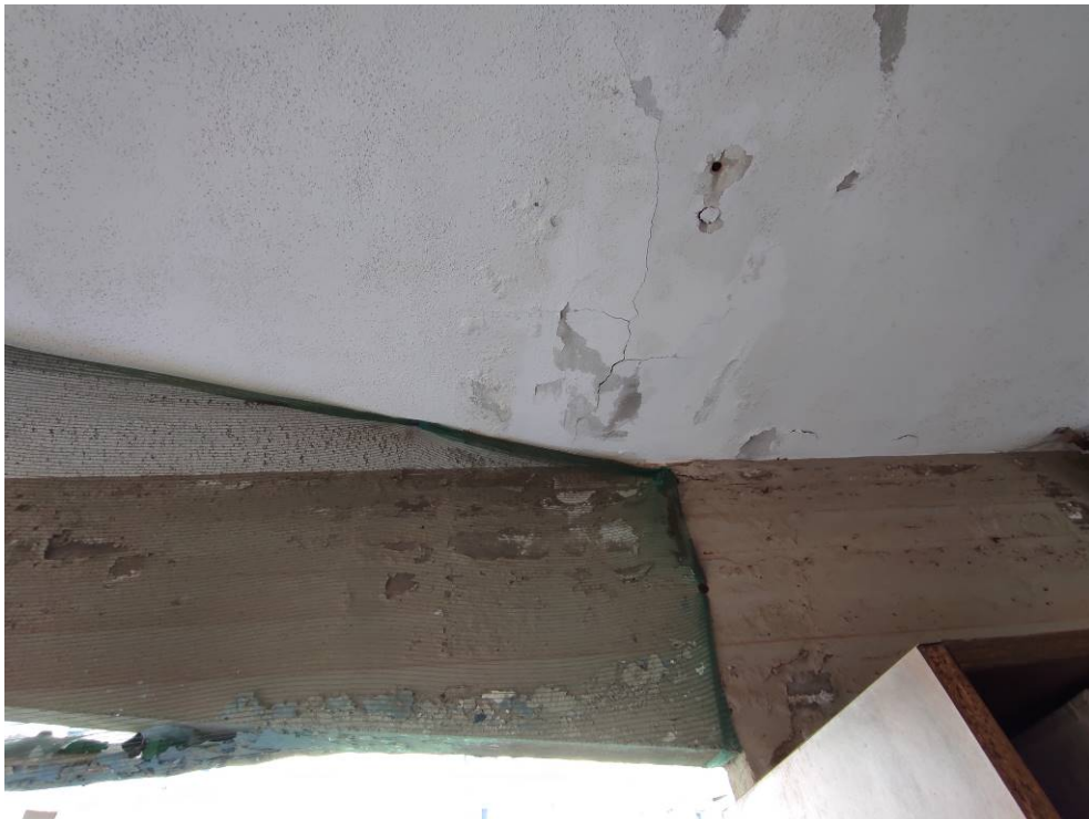
Foto 23 - - balcone 2, pessime condizioni di manutenzione
