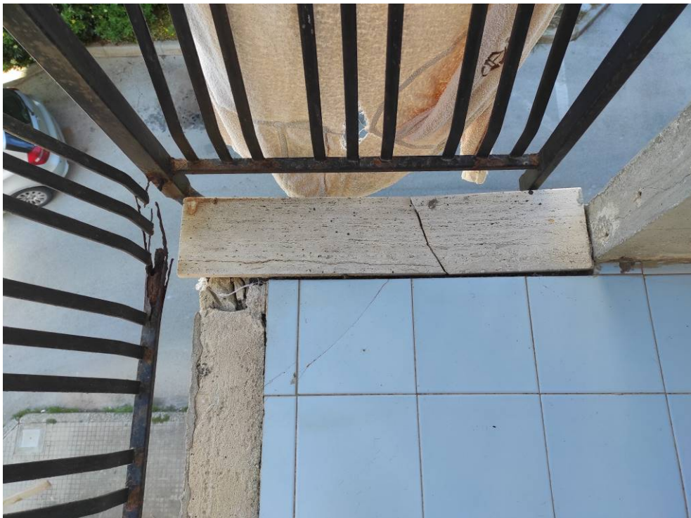
Foto 20 - balcone 2, pessime condizioni di manutenzione
