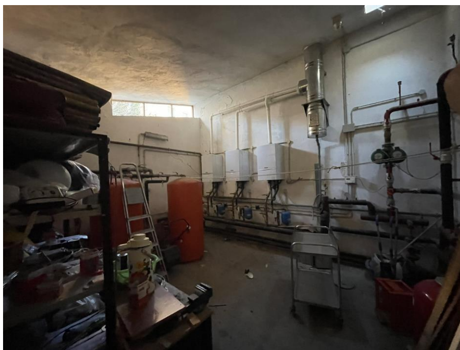
Fotografia n.11 – Piano Terra – L’Ambiente “Centrale Termica”.
