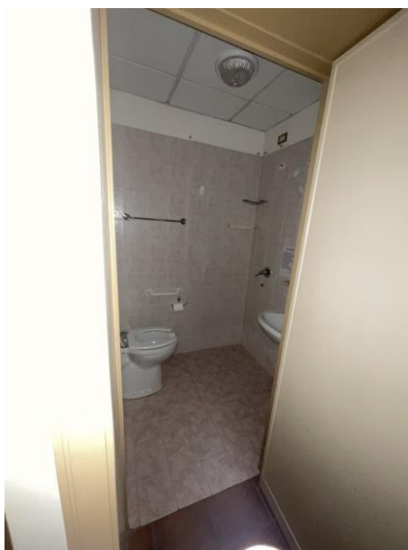
Fotografia n.21 – Piano Primo – Camera n.110 – L'alloggio tipo distribuito sui diversi piani – Ambiente Bagno.
