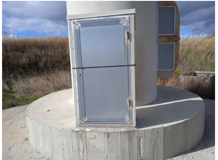
Foto n. 28 – Vista pala eolica – vano contatore
