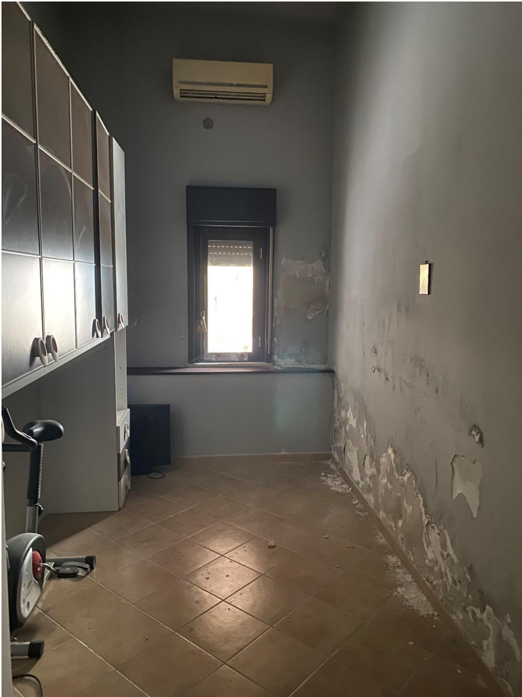
Vista ammaloramenti diffusi nella camera da letto singola prospiciente cortile interno
