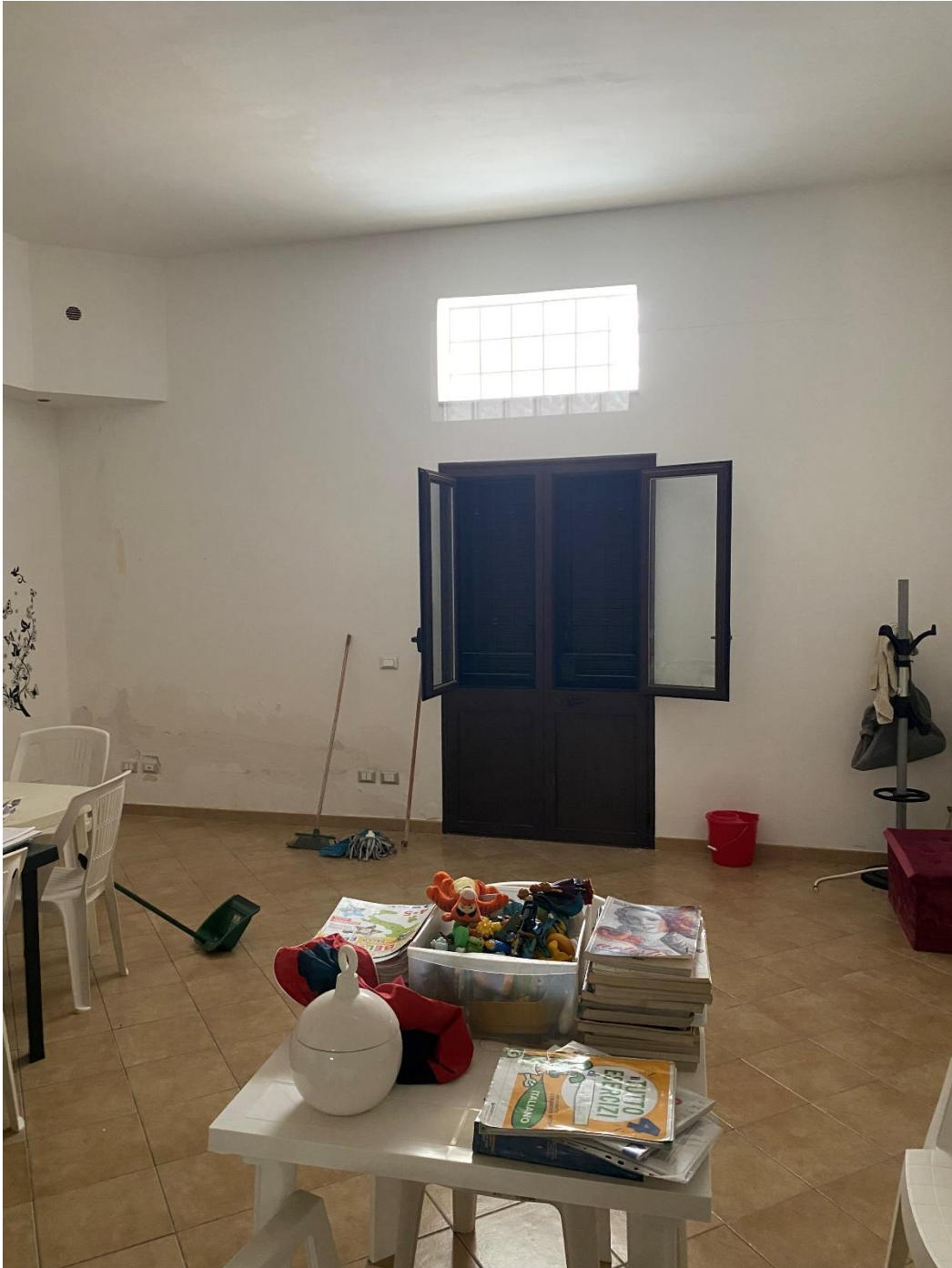
Vista ammaloramenti diffusi nel locale deposito prospiciente la via Donizzetti
