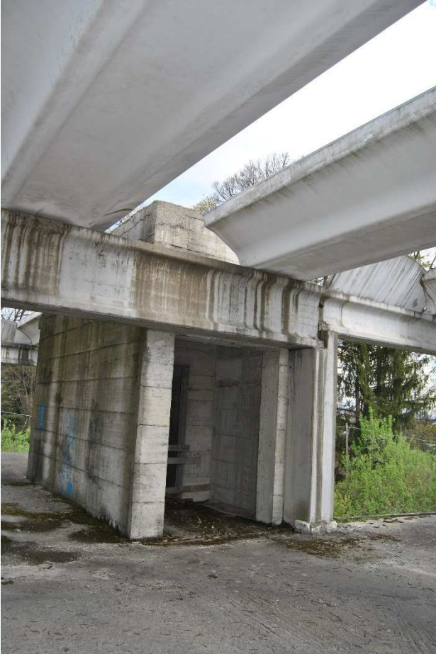
Foto 5 : particolare copertura con solaio prefabbricato privo di lucernari
