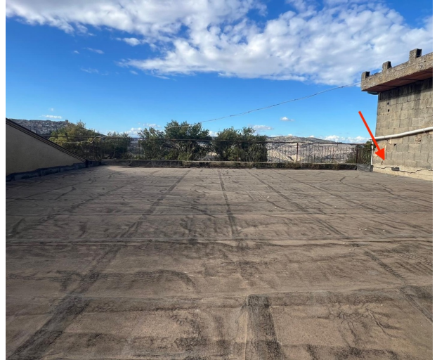
Figura 11 – lastrico solare – scollamento del risvolto della guaina
