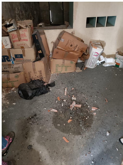
Figura 3 – Interno del LOTTO 9 – segno di gocciolamento e caduta di laterizi dal solaio di copertura
