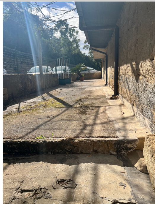
Figura 6 – Particolare del prospetto sulla via Pantalica parzialmente al di sotto del piao stradale
