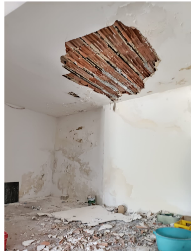
Figura 13 – Immobile sottostante il LOTTO 9 particolare del soffitto/solaio intermedio
