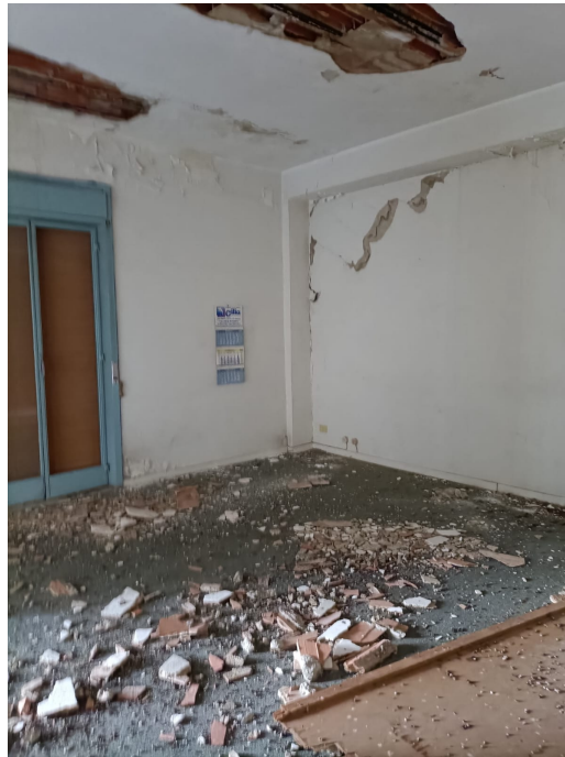
Figura 4 – Interno del LOTTO 9 – segno di gocciolamento e caduta di laterizi dal solaio di copertura
