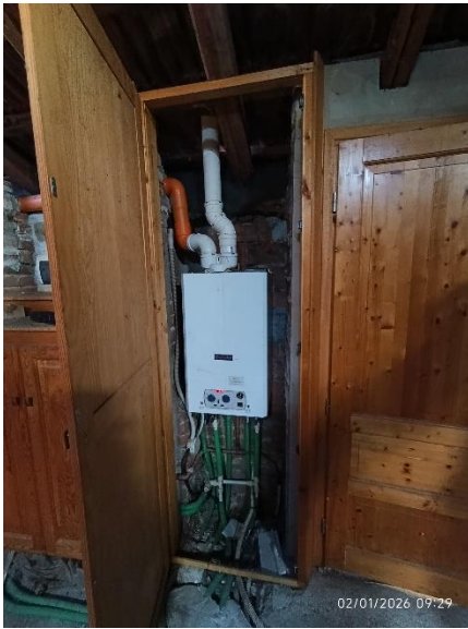
CALDAIA IMPIANTO IDRICO E DI RISCALDAMENTO
