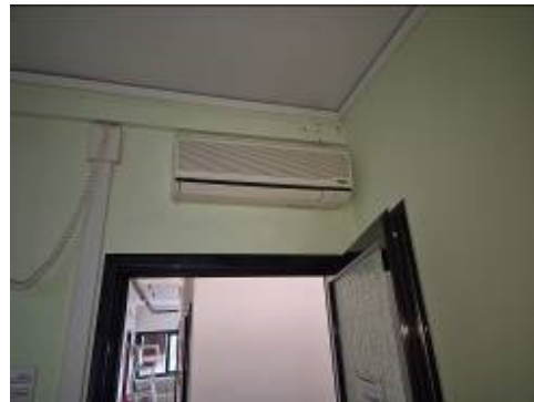
Condizionatore – Ufficio centrale lato sud-ovest
