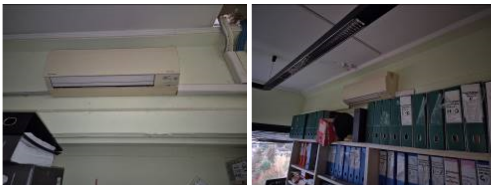
Condizionatore – Ufficio grande lato sud-ovest
