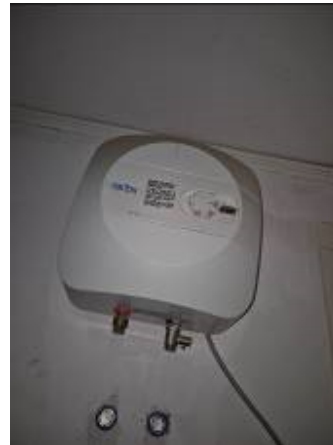
Scaldabagno – Bagno piano primo
