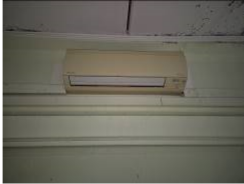
Condizionatore – Ufficio lato nord-est
