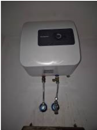
Scaldabagno – Bagno piano terra
