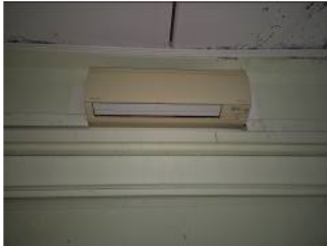
Condizionatore – Ufficio lato nord-est
