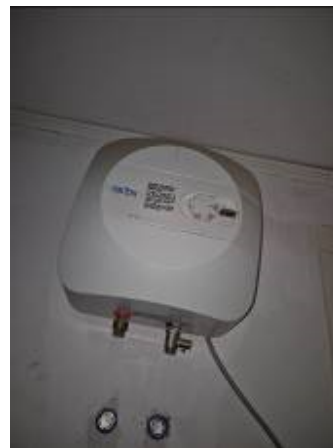
Scaldabagno – Bagno piano primo
