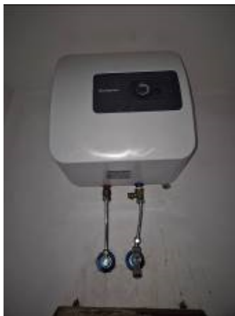
Scaldabagno – Bagno piano terra
