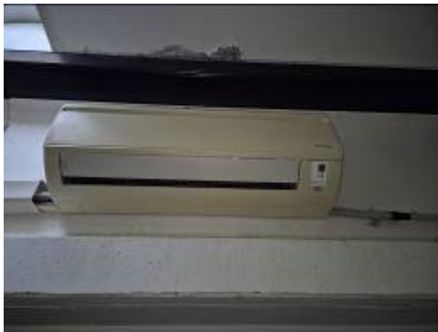
Condizionatore – Locale Server
