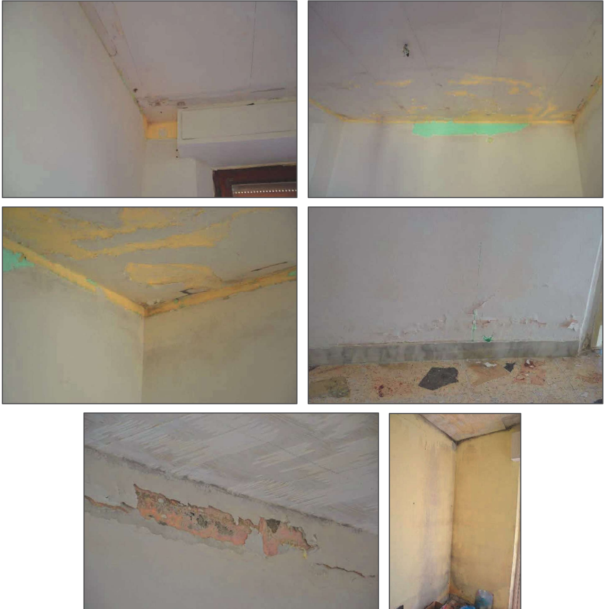
Figura 11 – Deterioramento delle finiture interne
