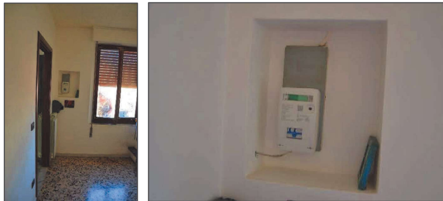
Figura 17 - Contatore energia elettrica
