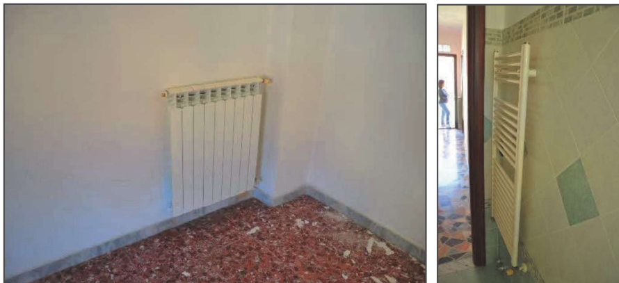
Figura 18 – terminali impianto di riscaldamento
