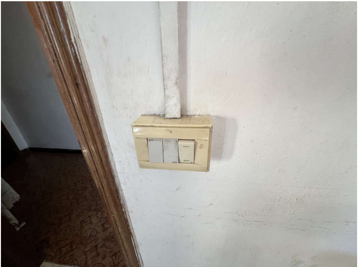
Foto 18 - particolare impianto elettrico
