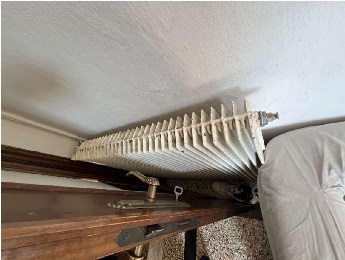
Foto 19 - particolare terminali emissione e porte interne
