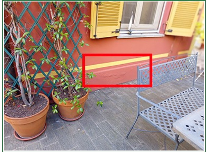
Fenomeni di umidità di risalita in esterno
