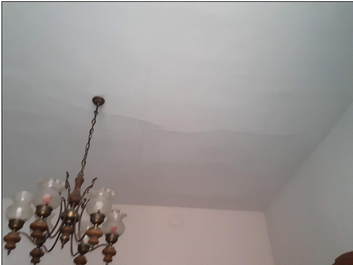
Foto n° 4 – soggiorno: lesione su controsoffitto
