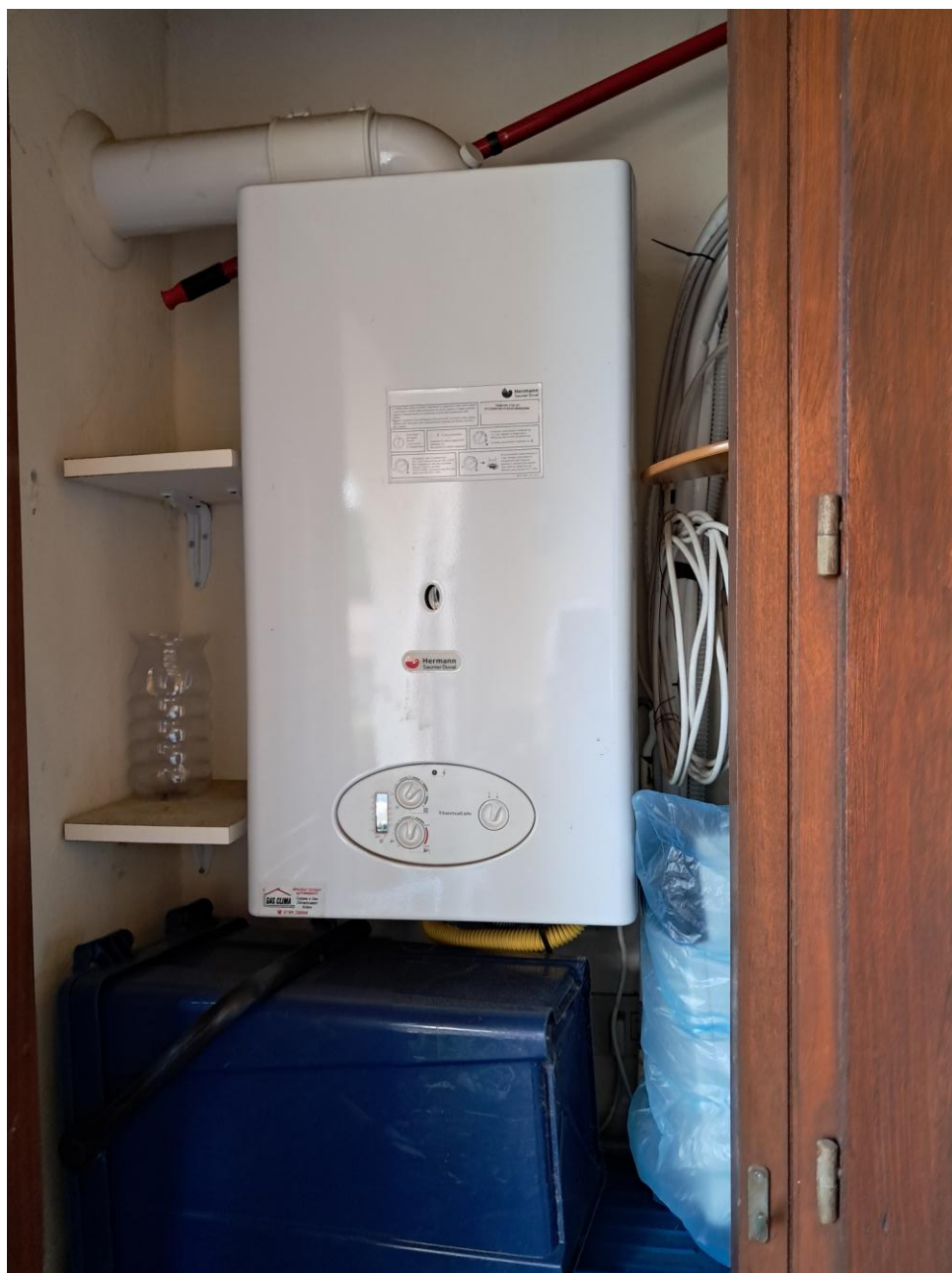
Foto n 9: La caldaia a gas ubicata nella veranda
