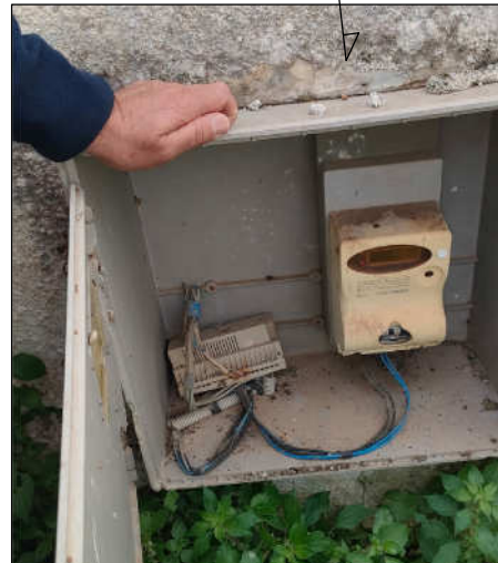
Contatore energia elettrica
