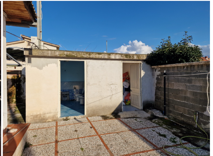
5 | vista del corpo abusivo all'interno della corte
