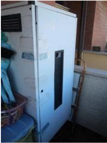
Caldia presente appartamento Sub.4
