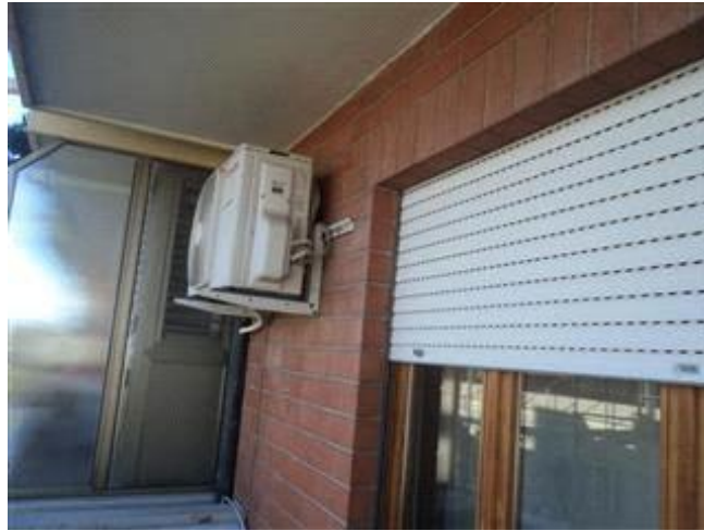
Condizionatore zona giorno appartamento Sub.4
