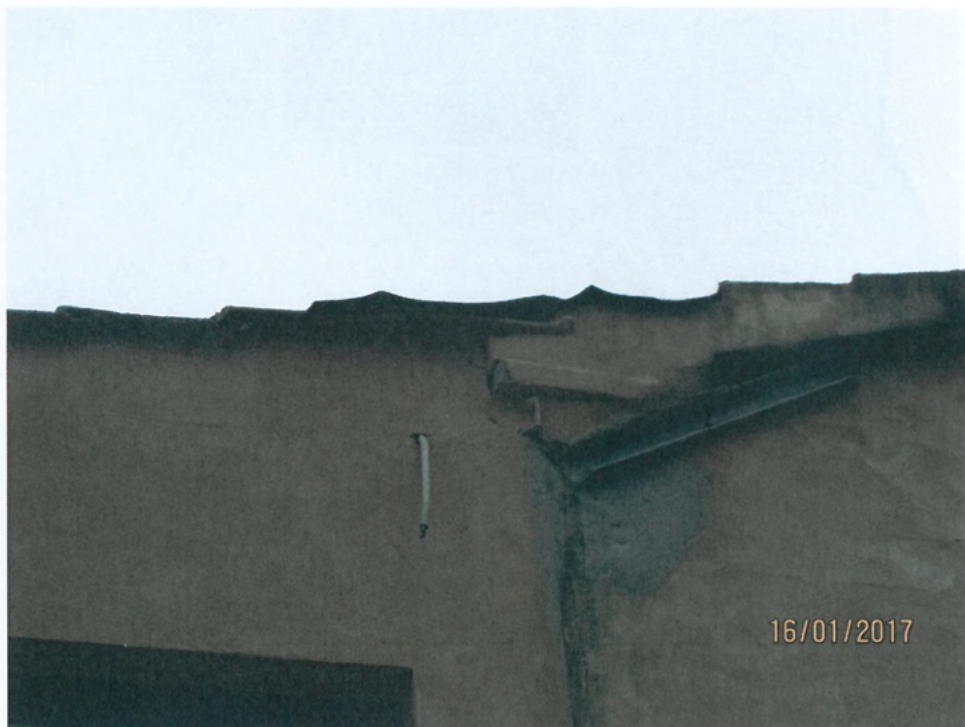
Foto 28.a - Lesioni passanti ad andamento pressochè verticali in corrispondenza di incroci fra muri (Tipo 7) Prospetto Nord-Est - Piano Primo - Maschio Murario su Vano Scala - Esterno
