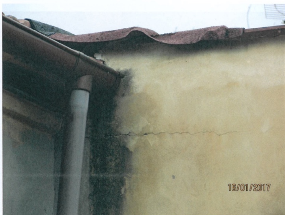
Foto 31 - Lesioni ad andamento orizzontale in corrispondenza dei solai o del sottotetto (Tipo 11) Prospetto Sud-Ovest - Piano Primo - Copertura su Vano Scala
