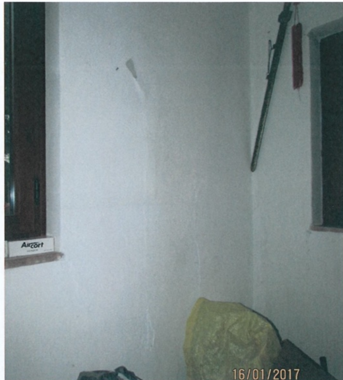
Foto 26.b - Lesioni passanti ad andamento pressochè verticali in corrispondenza di incroci fra muri (Tipo 7) Prospetto Sud-Est - Piano Terra - Maschio Murario su Vano Scala - Interno Eterogeneità Muratura
