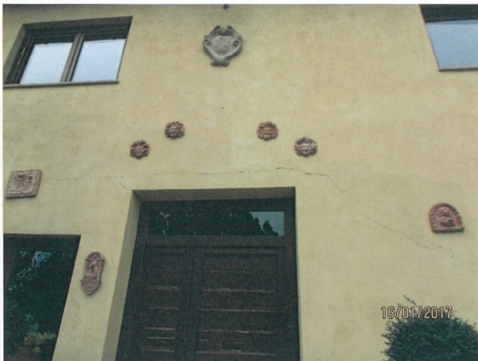
Foto 30 - Lesioni ad andamento orizzontale in corrispondenza dei solai o del sottotetto (Tipo 11) Prospetto Sud-Est - Piano Terra/Piano Primo - Solaio su Vano Scala
