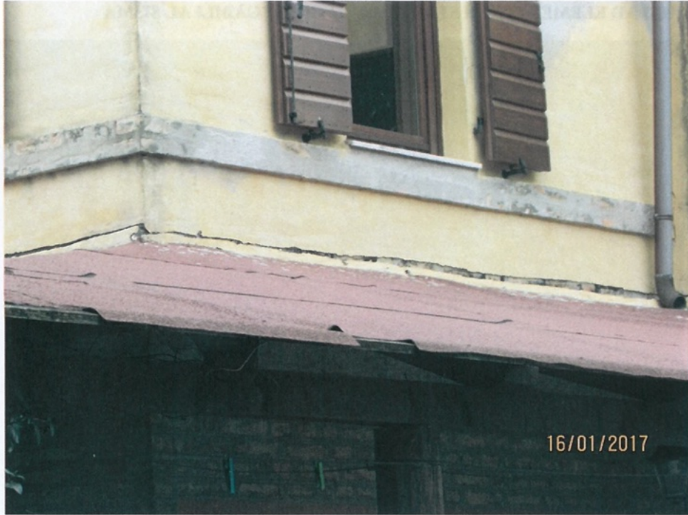
Foto 52 - Distacco Tipo Porticato in Legno Piano Terra - Angolo Prospetto Sud-Est/Prospetto Sud-Ovest
