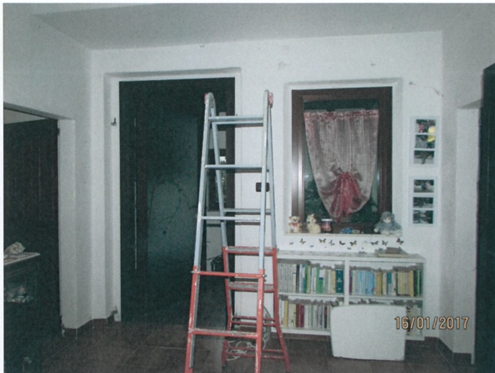
Foto 20.a - Lesioni ad andamento pressochè orizzontale in testa e/o al piede di maschi murari (Tipo 5) Piano Primo - Disimpegno - Maschio Murario su Vano Scala
