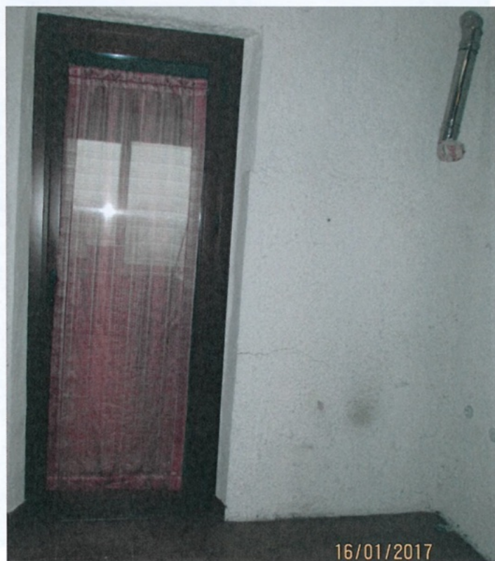
Foto 24 - Lesioni ad andamento pressochè orizzontale in testa e/o al piede di maschi murari (Tipo 5) Piano Primo - Disimpegno - Maschio Murario su Veranda
