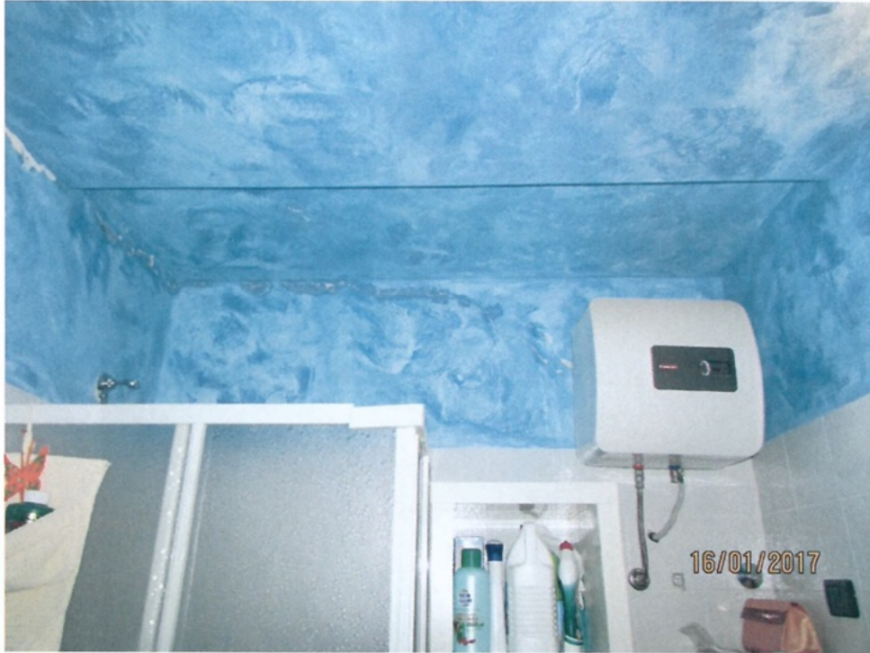
Foto 12 - Lesioni ad andamento diagonale in elementi verticali (Tipo 3) Piano Terra - Bagno - Maschio Murario lato Nord-Ovest
