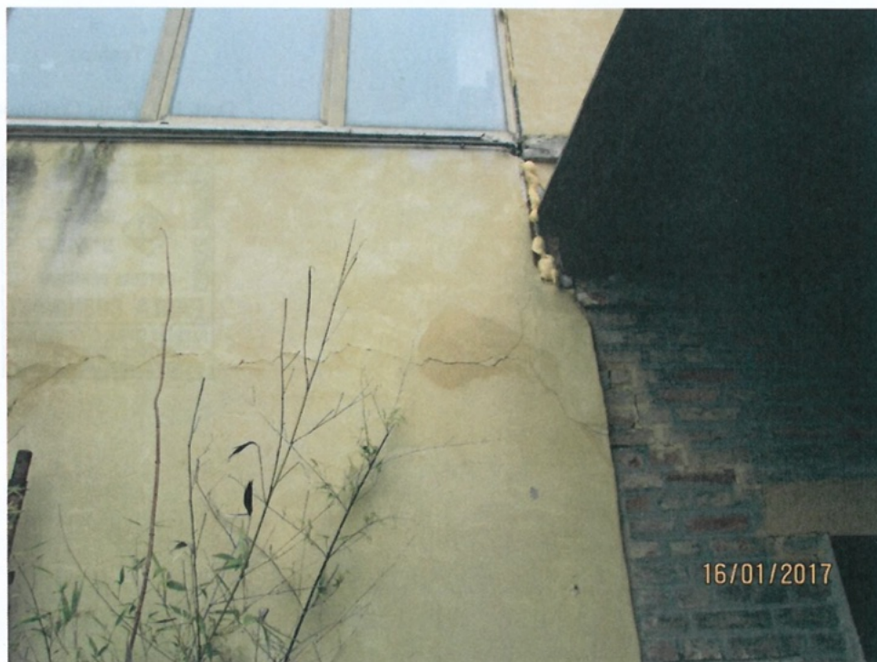
Foto 51 - Distacco Tipo Veranda Piano Primo - Sopra Garage
