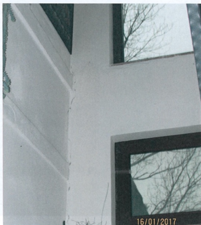
Foto 28.b - Lesioni passanti ad andamento pressochè verticali in corrispondenza di incroci fra muri (Tipo 7) Prospetto Nord-Est - Piano Terra/Piano Primo - Maschio Murario su Vano Scala - Interno
