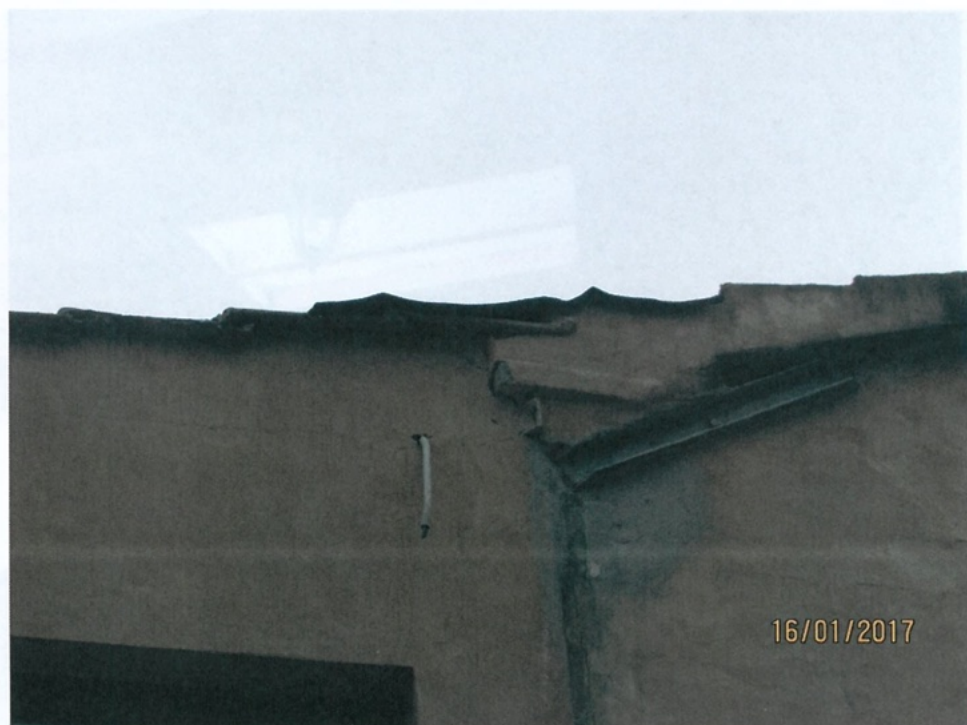
Foto 37 - Lesioni ad andamento orizzontale in corrispondenza dei solai o del sottotetto (Tipo 11) Prospetto Nord-Est - Piano Primo - Copertura su Nucleo Originario e su Vano Scala
