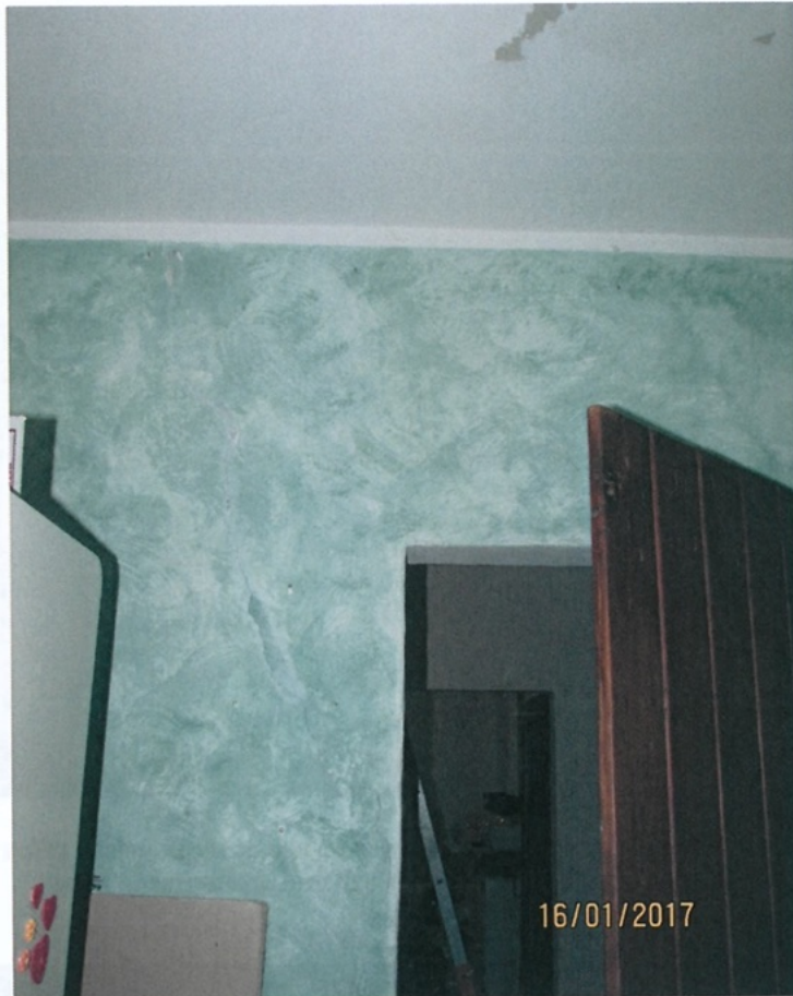
Foto 14 - Lesioni ad andamento diagonale in elementi verticali (Tipo 3) Piano Primo - Camera 1 - Maschio Murario di controvento
