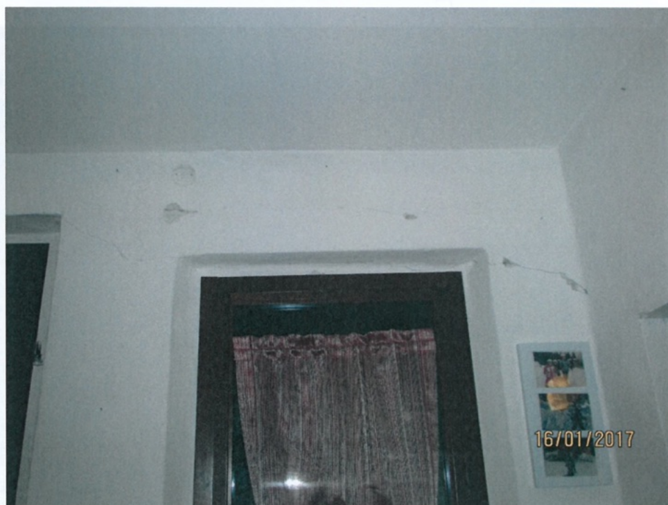
Foto 20.b - Lesioni ad andamento pressochè orizzontale in testa e/o al piede di maschi murari (Tipo 5) Piano Primo - Disimpegno - Maschio Murario su Vano Scala Dettaglio
