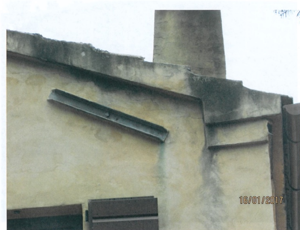
Foto 36 - Lesioni ad andamento orizzontale in corrispondenza dei solai o del sottotetto (Tipo 11) Prospetto Nord-Est - Piano Primo - Copertura su Nucleo Originario
