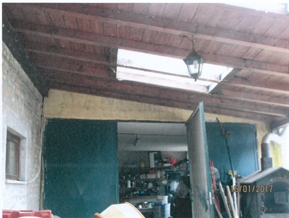
Foto 35 - Lesioni ad andamento orizzontale in corrispondenza dei solai o del sottotetto (Tipo 11) Prospetto Nord-Est - Piano Terra - Copertura su Garage
