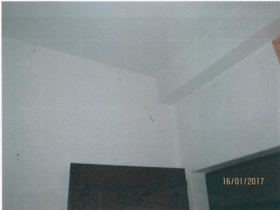
Foto 46 - Lesioni su tramezzi Piano Primo - Divisorio Camera 3/Camera 2
