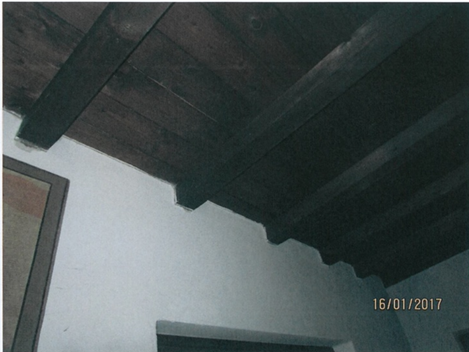
Foto 40 - Distacchi ben definiti fra solaio e strutture portanti Piano Primo - Vano Scala - Solaio/Parete Esterna
