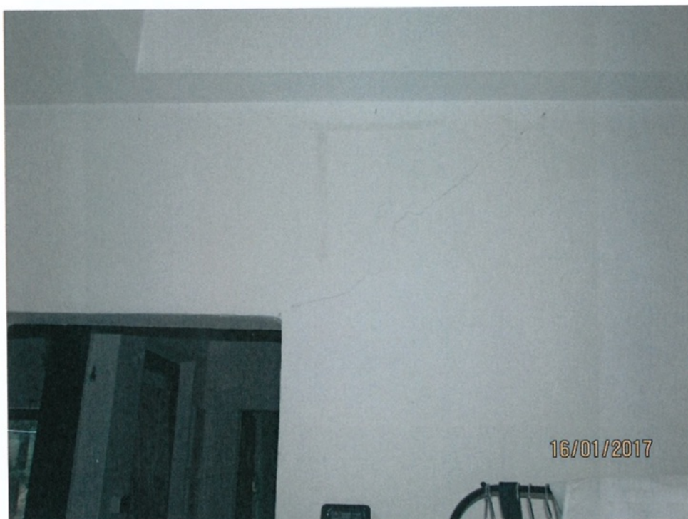
Foto 25 - Lesioni ad andamento pressochè orizzontale in testa e/o al piede di maschi murari (Tipo 5) Piano Primo - Camera 2 - Maschio Murario su Parete di Controvento - Porta su Disimpegno
