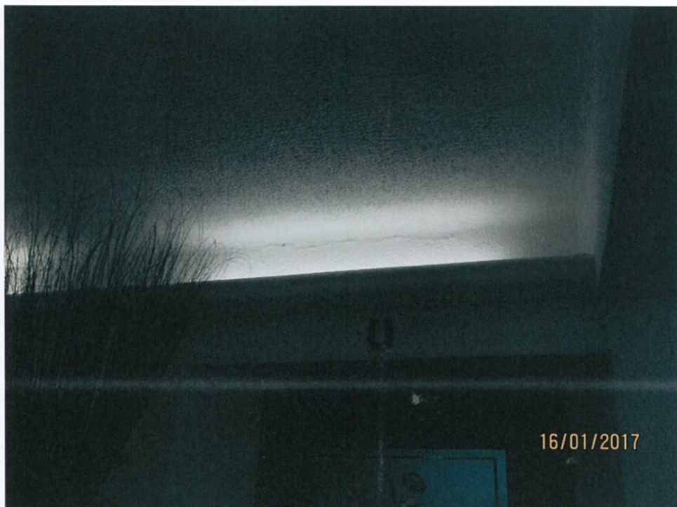
Foto 41 - Distacchi ben definiti fra solaio e strutture portanti Piano Terra - Pranzo Soggiorno - Solaio/Parete Nucleo Originario Lato Sud-Est
