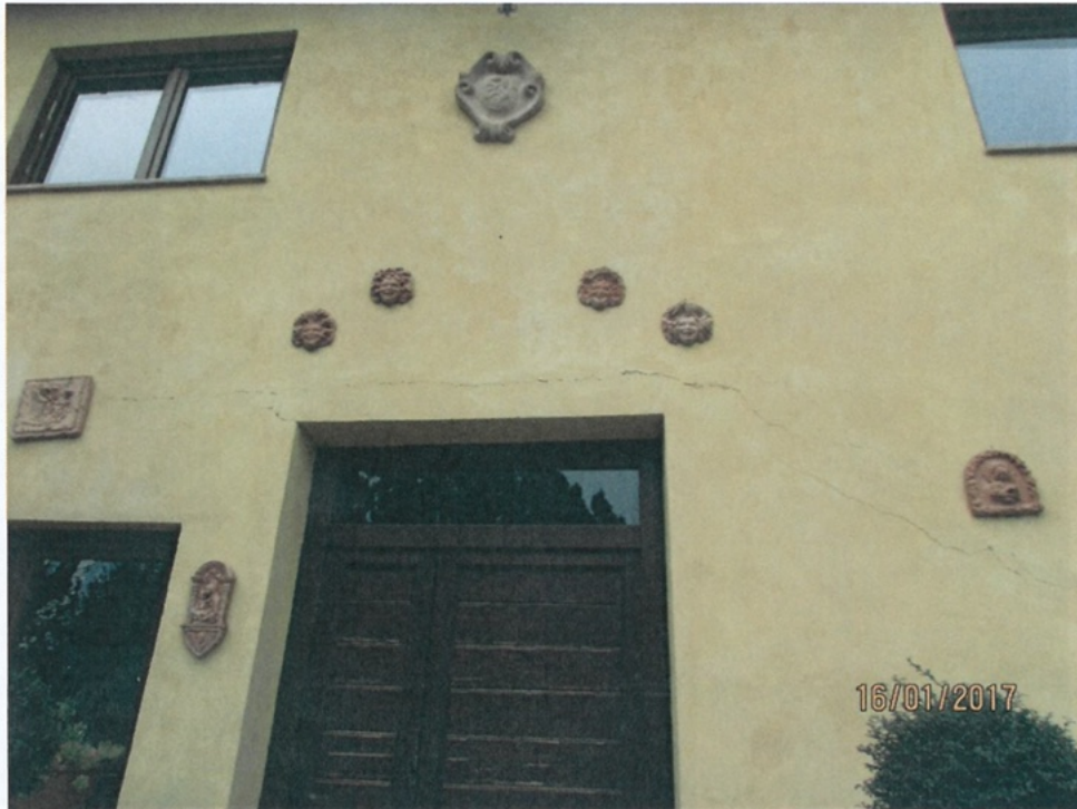
Foto 16 - Lesioni ad andamento pressochè orizzontale in testa e/o al piede di maschi murari (Tipo 5) Prospetto Sud-Est - Piano Terra - Maschio Murario su Vano Scala
