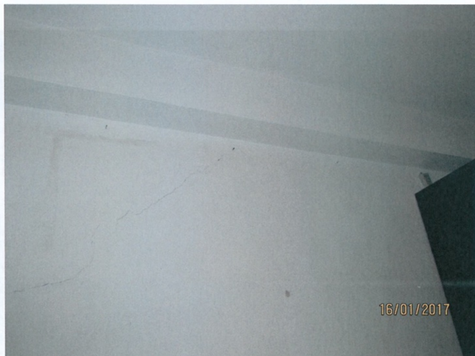
Foto 47 - Lesioni su tramezzi Piano Primo - Divisorio Camera 2/Camera 3
