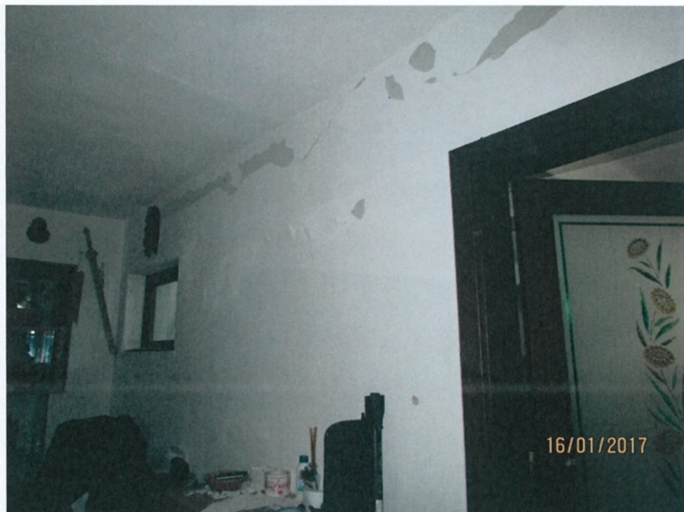
Foto 39 - Distacchi ben definiti fra solaio e strutture portanti Piano Terra - Vano Scala - Solaio/Parete Nucleo Originario
