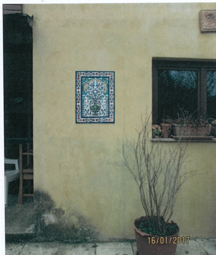
Foto 26.a - Lesioni passanti ad andamento pressochè verticali in corrispondenza di incroci fra muri (Tipo 7) Prospetto Sud-Est - Piano Terra - Maschio Murario su Vano Scala - Esterno
