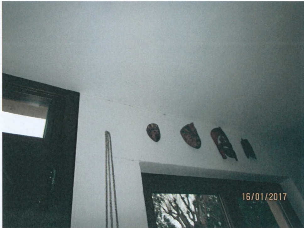
Foto 38 - Distacchi ben definiti fra solaio e strutture portanti Piano Terra - Vano Scala - Solaio/Parete esterna
