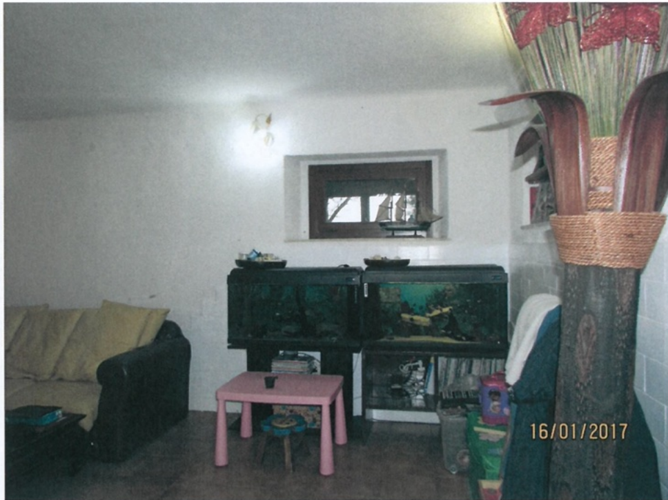
Foto 11.a - Lesioni ad andamento diagonale in elementi verticali (Tipo 3) Piano Terra - Pranzo Soggiorno - Maschio Murario lato Nord-Est
