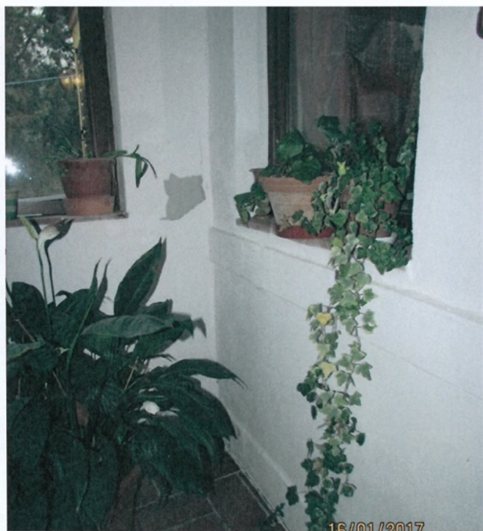
Foto 27.c - Lesioni passanti ad andamento pressochè verticali in corrispondenza di incroci fra muri (Tipo 7) Prospetto Sud-Ovest - Piano Primo - Maschio Murario su Vano Scala - Interno
