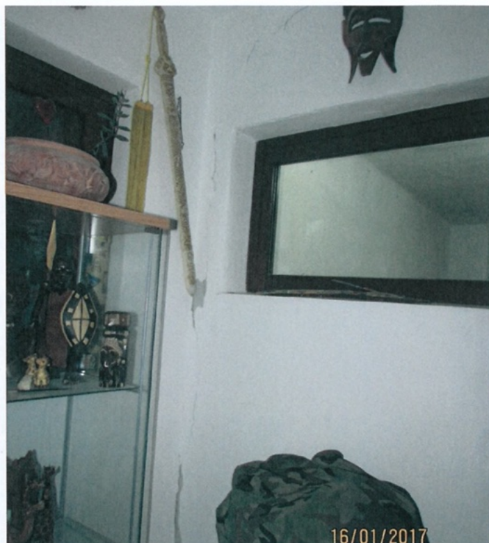
Foto 27.b - Lesioni passanti ad andamento pressochè verticali in corrispondenza di incroci fra muri (Tipo 7) Prospetto Sud-Ovest - Piano Terra - Maschio Murario su Vano Scala - Interno
