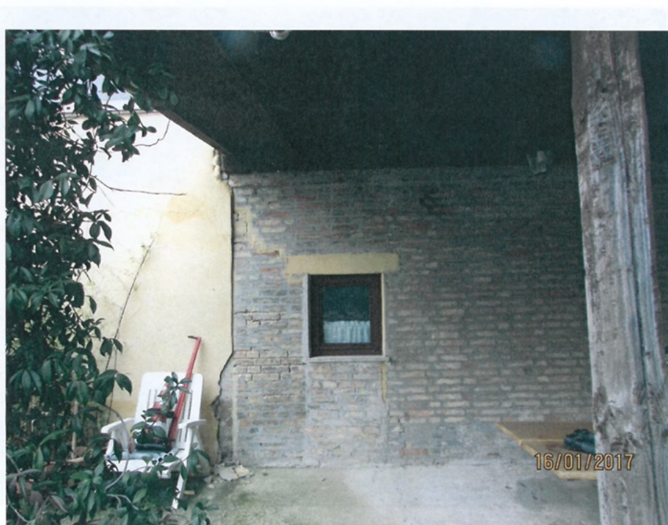
Foto 10 - Lesioni ad andamento diagonale in elementi verticali (Tipo 3) Prospetto Sud-Ovest - Piano Terra - Maschio Murario su Bagno
