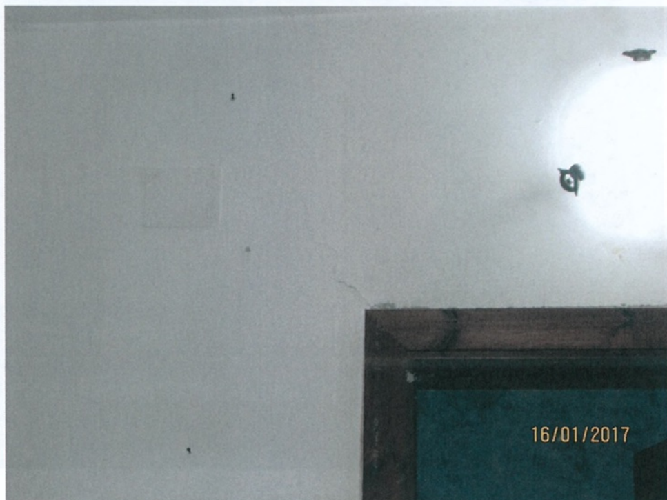
Foto 45 - Lesioni su tramezzi Piano Terra - Divisorio Studio/Bagno
