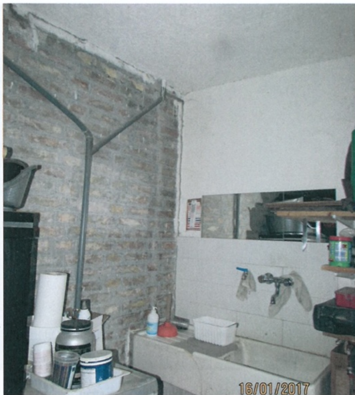
Foto 44 - Distacchi ben definiti fra solaio e strutture portanti Piano Terra - Garage - Solaio/Parete Nucleo Originario
