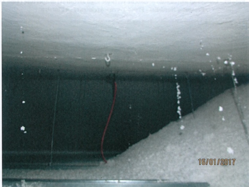
Foto 06 - Lesioni parallele all'orditura Piano Primo - Intradosso Copertura Nucleo Originario
