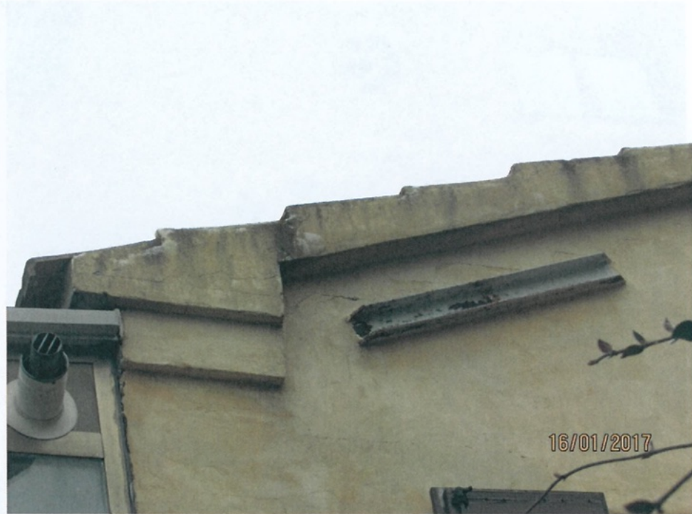
Foto 32 - Lesioni ad andamento orizzontale in corrispondenza dei solai o del sottotetto (Tipo 11) Prospetto Sud-Ovest - Piano Primo - Copertura su Nucleo Originario
