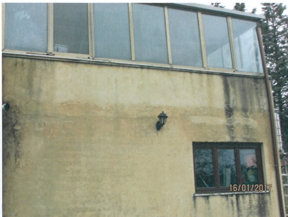
Foto 34 - Lesioni ad andamento orizzontale in corrispondenza dei solai o del sottotetto (Tipo 11) Prospetto Nord-Ovest - Piano Terra - Copertura su Garage
