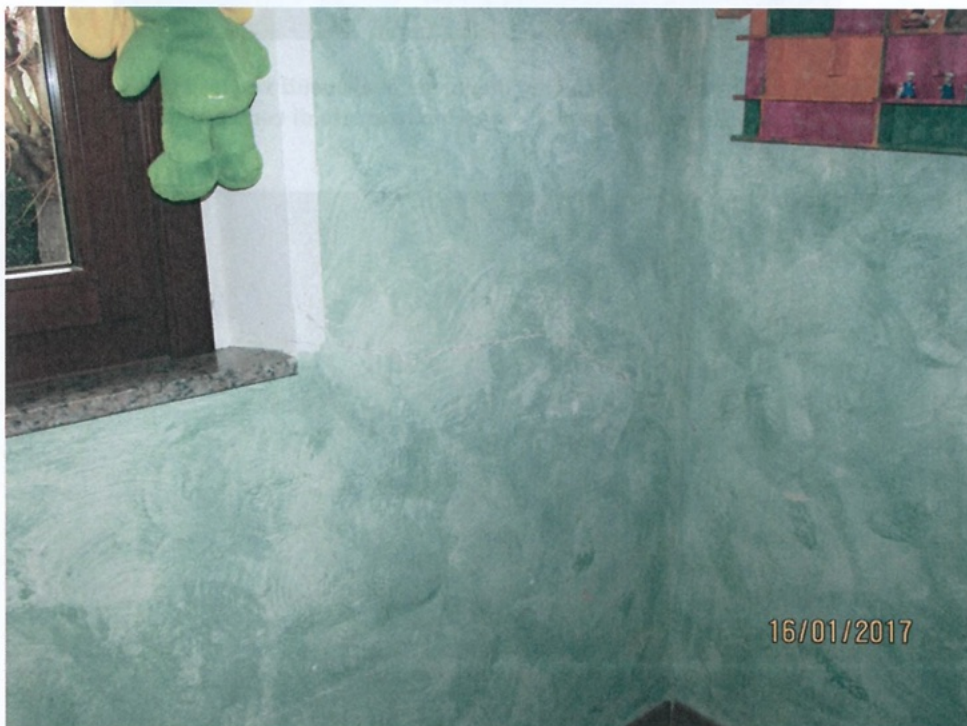
Foto 13 - Lesioni ad andamento diagonale in elementi verticali (Tipo 3) Piano Primo - Camera 1 - Maschio Murario lato Sud-Est
