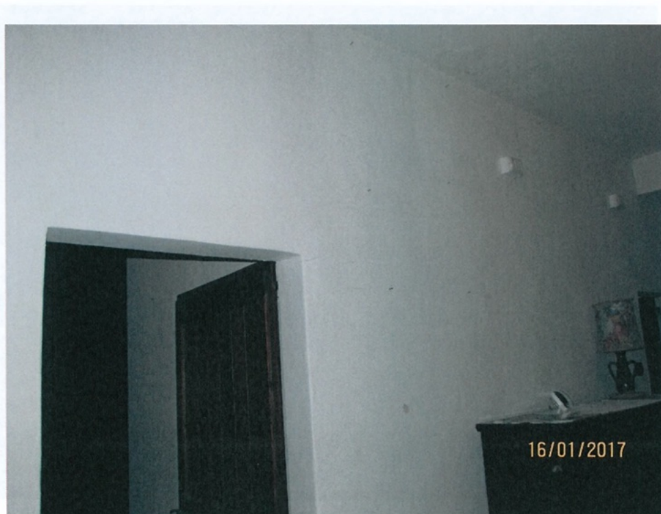
Foto 22 - Lesioni ad andamento pressochè orizzontale in testa e/o al piede di maschi murari (Tipo 5) Piano Primo - Disimpegno - Maschio Murario su Parete di Controvento - Porta su Camera 3
