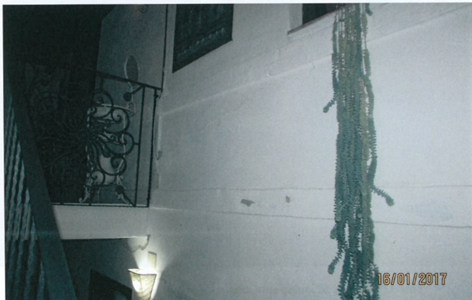
Foto 15 - Lesioni ad andamento diagonale in elementi verticali (Tipo 3) Piano Primo - Vano Scala - Maschio Murario su Nucleo Originario
