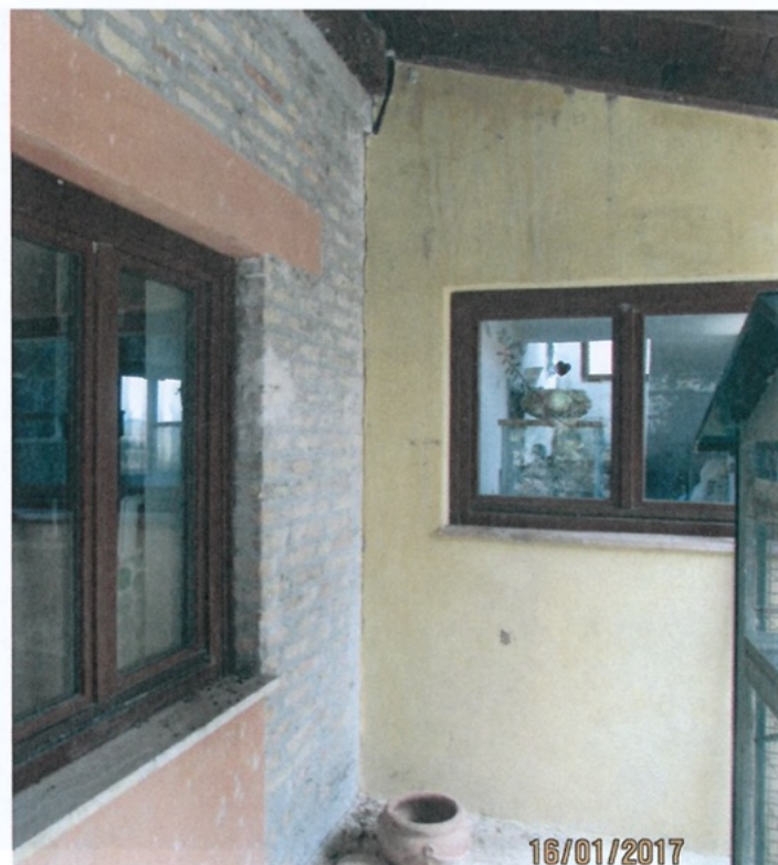
Foto 27.a - Lesioni passanti ad andamento pressochè verticali in corrispondenza di incroci fra muri (Tipo 7) Prospetto Sud-Ovest - Piano Terra/Piano Primo - Maschio Murario su Vano Scala - Esterno
