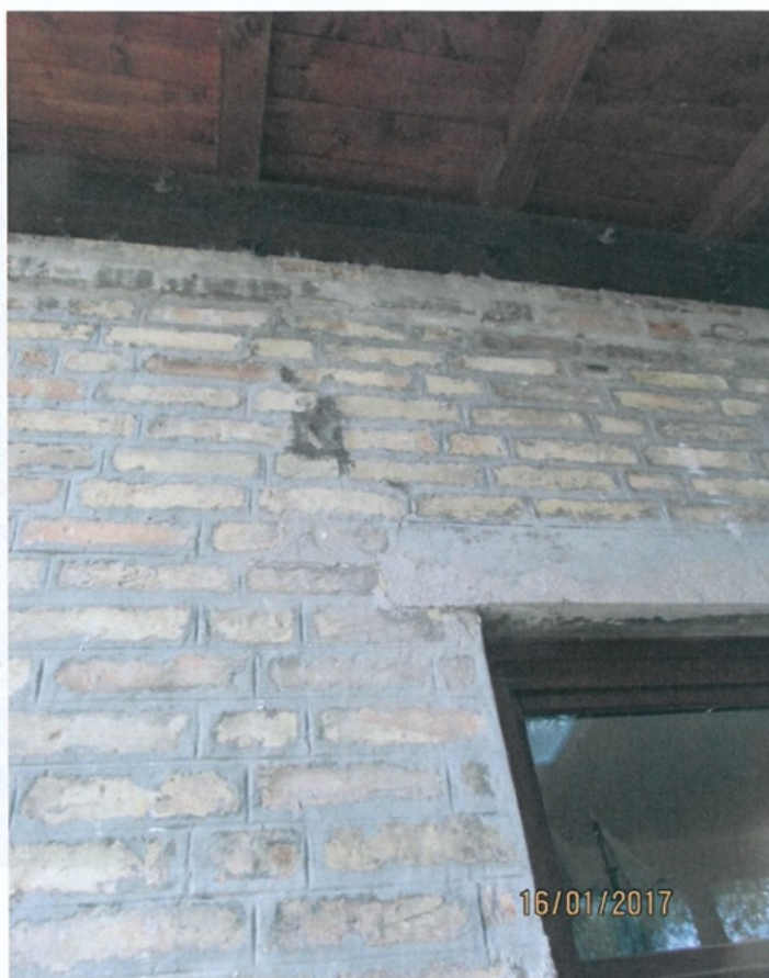
Foto 07 - Lesioni ad andamento pressochè verticale sugli architravi di aperture (Tipo 1) Prospetto Nord-Est - Piano Terra - Architrave su Finestra
