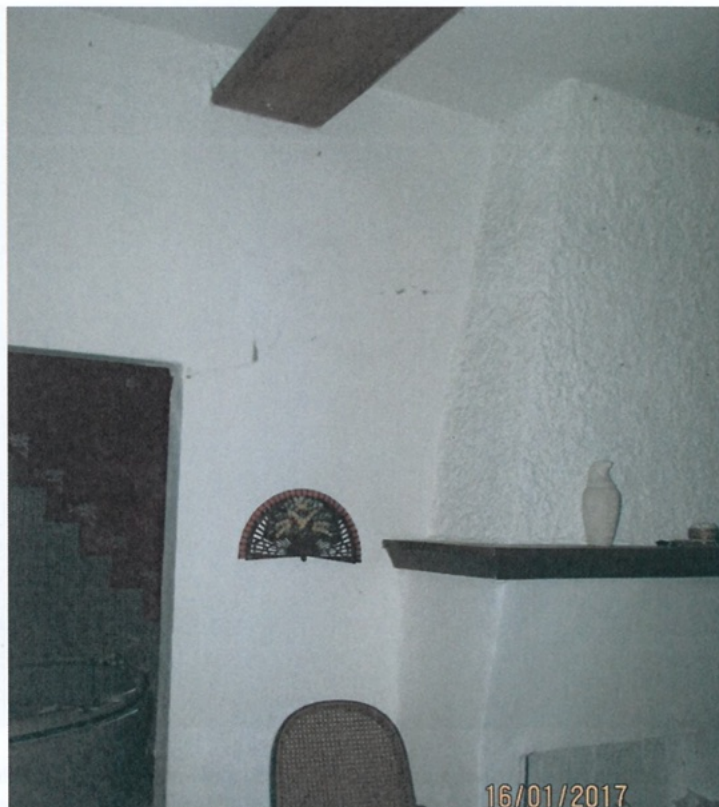
Foto 23 - Lesioni ad andamento pressochè orizzontale in testa e/o al piede di maschi murari (Tipo 5) Piano Primo - Disimpegno - Maschio Murario su Parete di Controvento - Porta su Bagno
