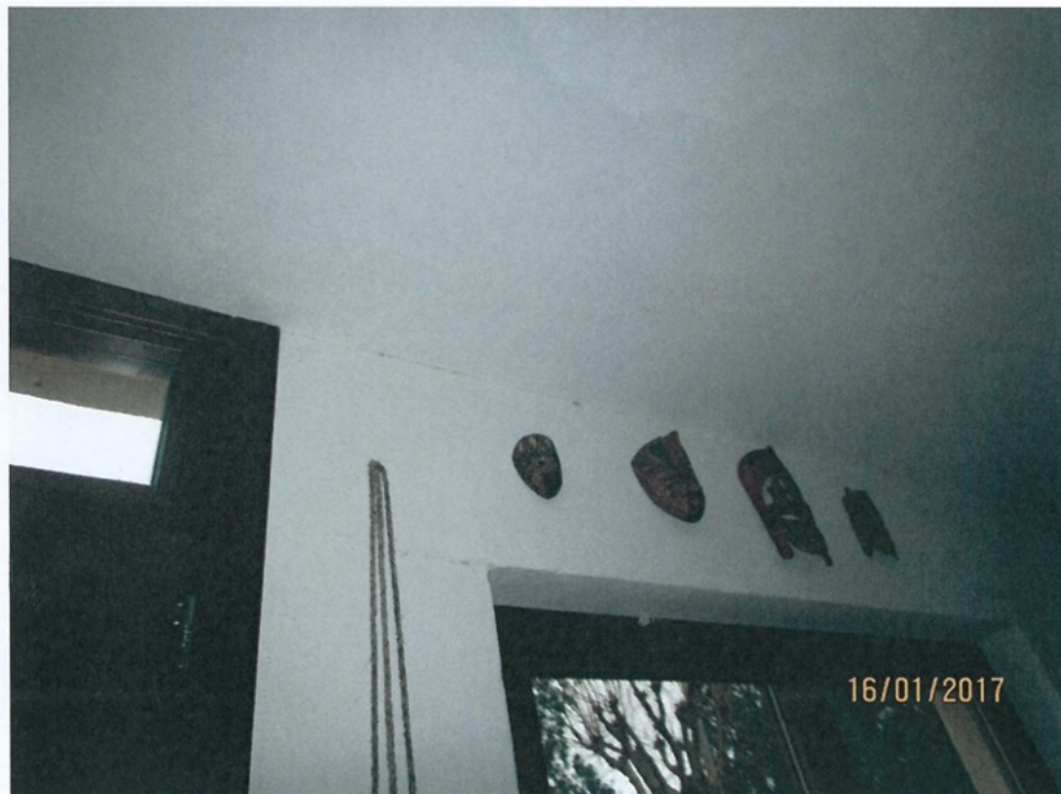
Foto 17 - Lesioni ad andamento pressochè orizzontale in testa e/o al piede di maschi murari (Tipo 5) Piano Terra - Vano Scala - Maschio Murario lato Prospetto Sud-Est
