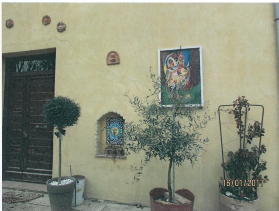
Foto 09 - Lesioni ad andamento diagonale in elementi verticali (Tipo 3) Prospetto Sud-Est - Piano Terra - Maschio Murario su Vano Scala
