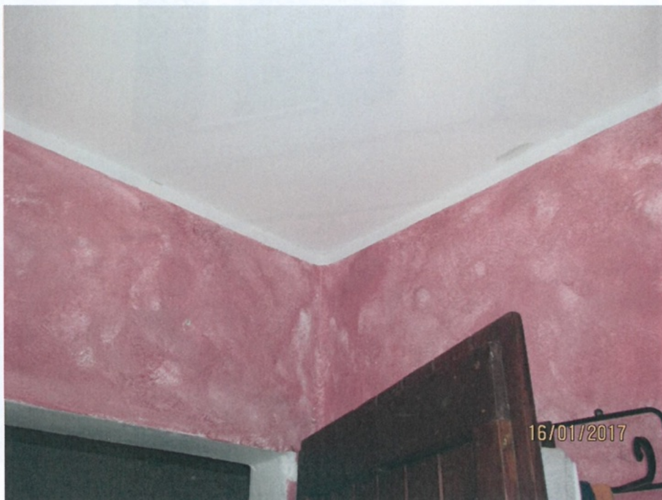
Foto 50 - Distacco Tipo Controsoffitto Piano Primo - Bagno
