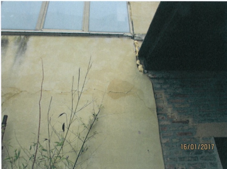
Foto 33 - Lesioni ad andamento orizzontale in corrispondenza dei solai o del sottotetto (Tipo 11) Prospetto Sud-Ovest - Piano Terra - Copertura su Garage
