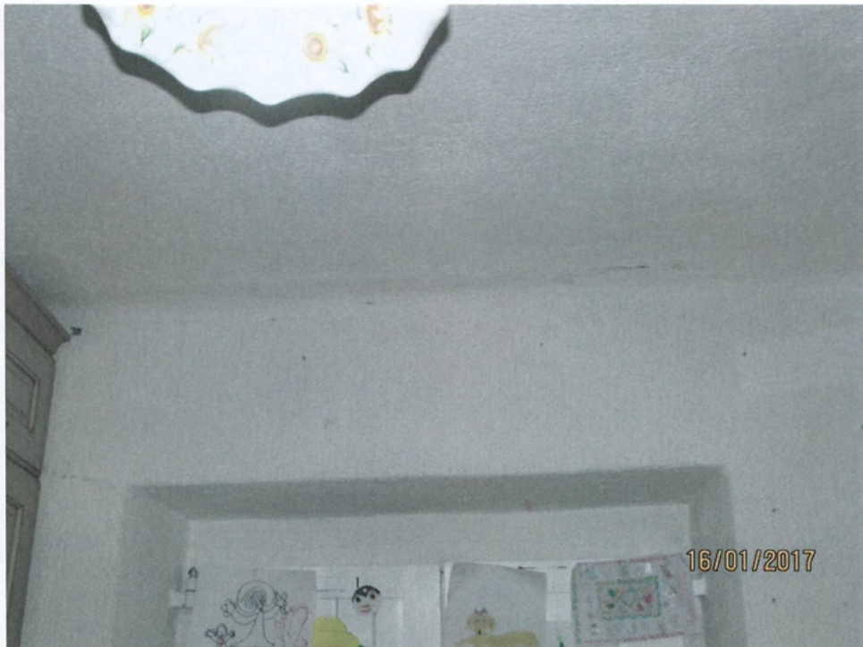
Foto 19 - Lesioni ad andamento pressochè orizzontale in testa e/o al piede di maschi murari (Tipo 5) Piano Terra - Cucina - Maschio Murario lato Prospetto Nord-Ovest
