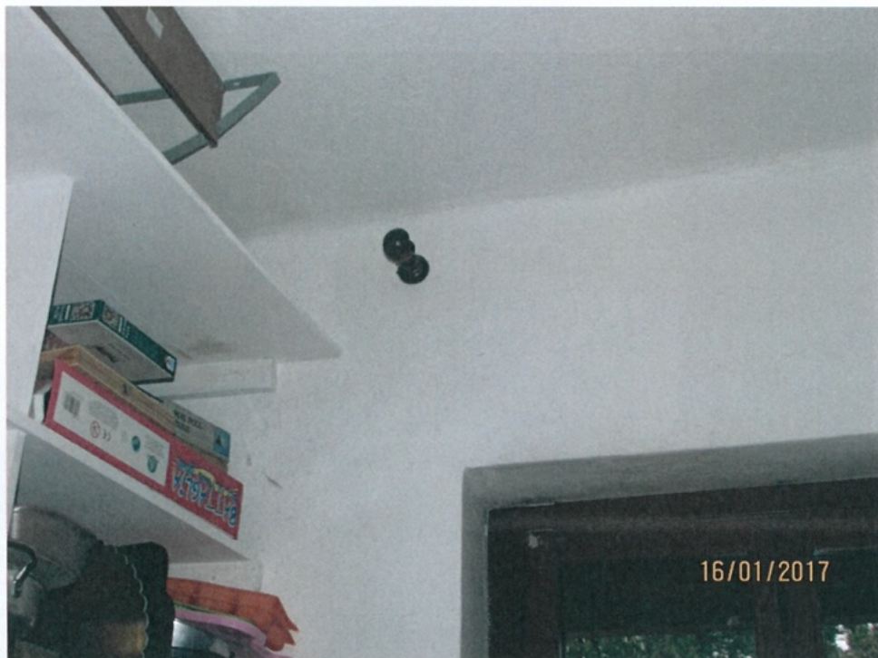
Foto 43 - Distacchi ben definiti fra solaio e strutture portanti Piano Terra - Studio - Solaio/Parete Esterna
