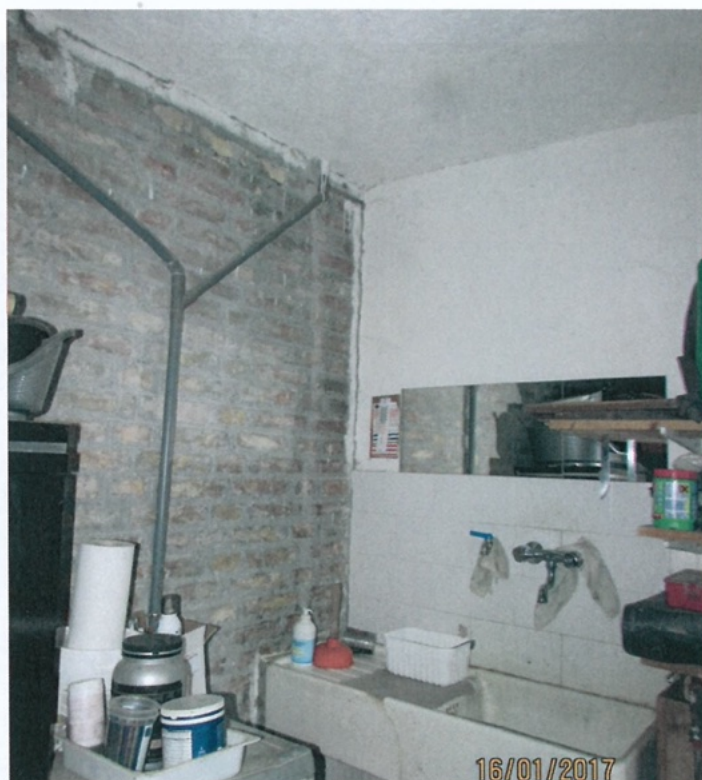
Foto 29.b - Lesioni passanti ad andamento pressochè verticali in corrispondenza di incroci fra muri (Tipo 7) Prospetto Sud-Ovest - Piano Terra - Maschio Murario Garage e Nucleo Originario - Interno
