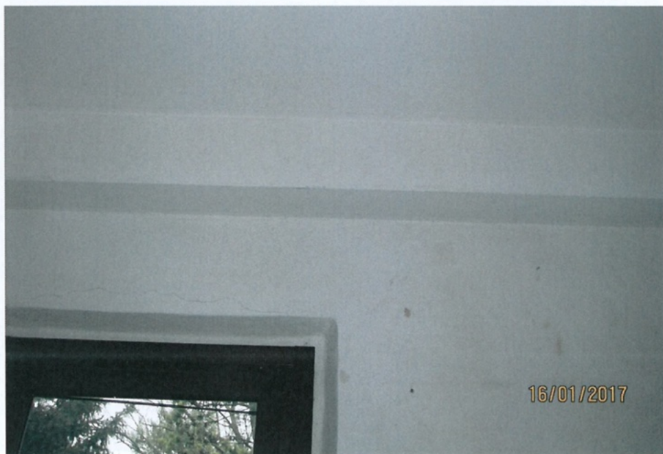
Foto 08 - Lesioni ad andamento pressochè verticale sugli architravi di aperture (Tipo 1) Piano Primo - Camera 3 - Architrave su Finestra
