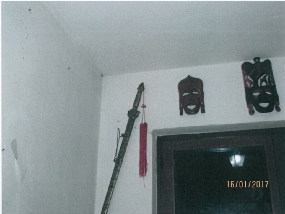
Foto 18 - Lesioni ad andamento pressochè orizzontale in testa e/o al piede di maschi murari (Tipo 5) Piano Terra - Vano Scala - Maschio Murario lato Prospetto Sud-Ovest
