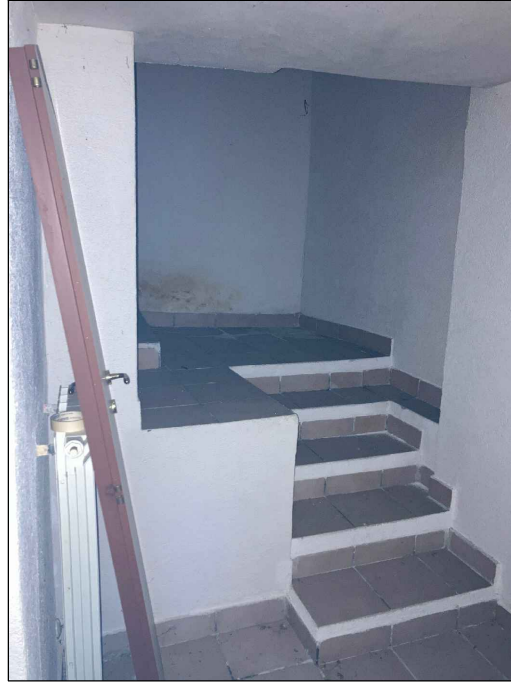
Foto 13 - DISIMPEGNO CON SCALA
