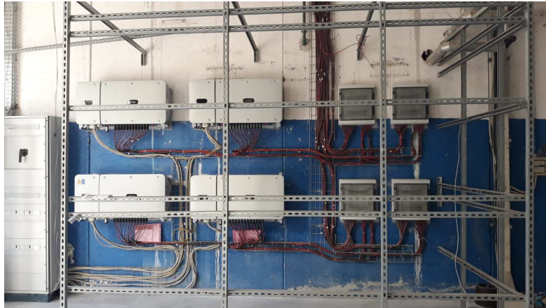
quadri elettrici (opificio sub 6)
