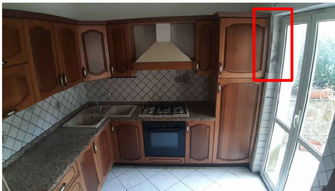
foto 9 - vista della cucina al piano terra con le infiltrazioni provenienti dalla facciata.
