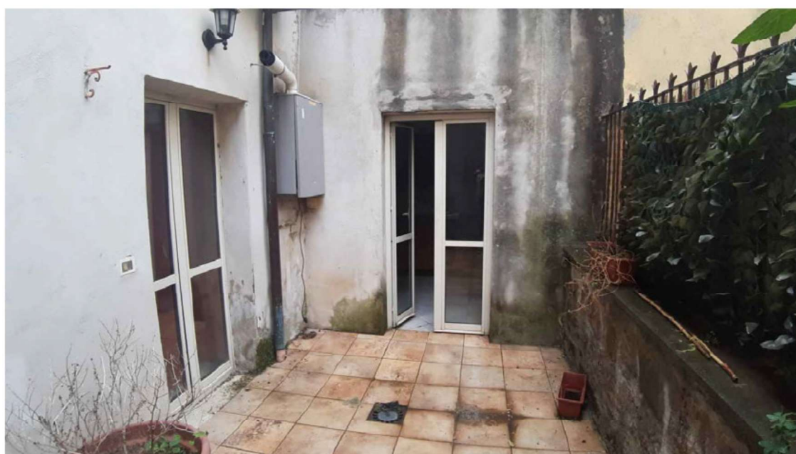
foto 12 - come sopra da altra angolazione con le evidenti infiltrazioni sulla facciata.
