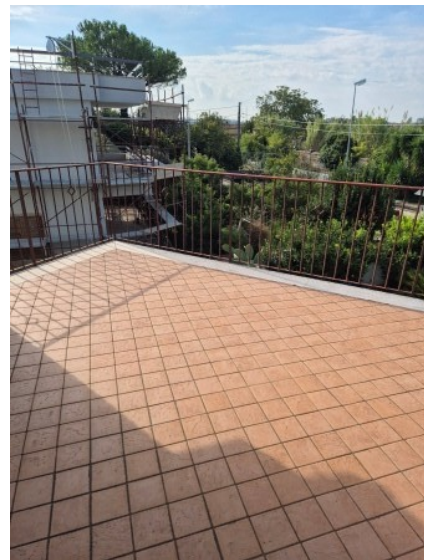
Figura 28 balcone 2 primo piano
