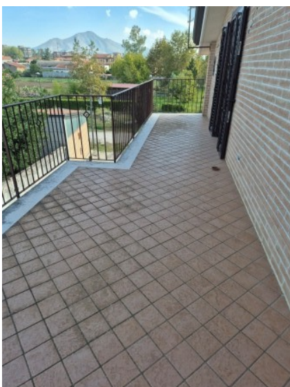
Figura 30 balcone 1 primo piano
