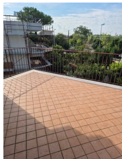
Figura 31 balcone 2 primo piano
