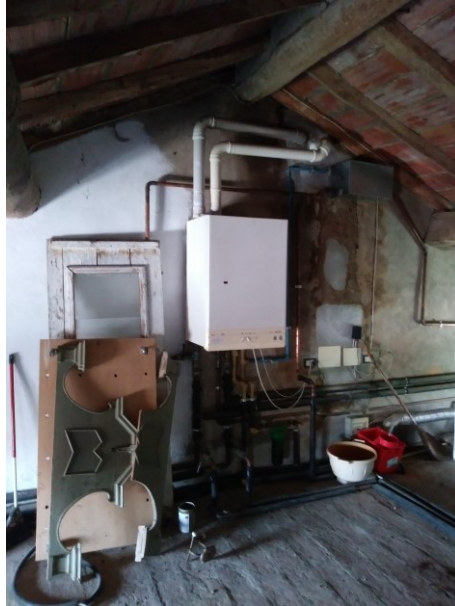
11 caldaia nel sottotetto
