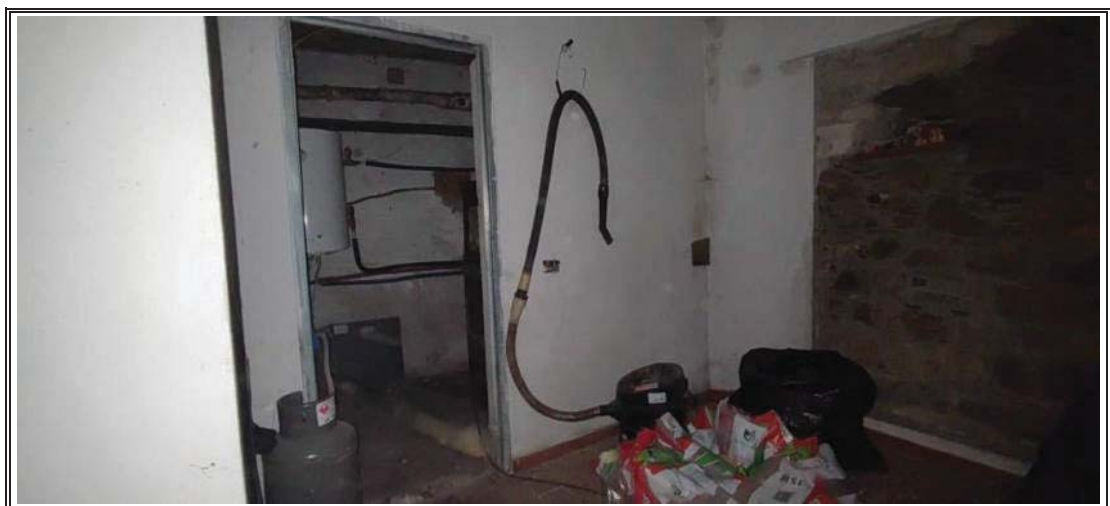
Foto n. 15 – Piano terra – Locale caldaia
