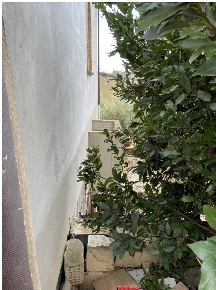
Foto n. 11 - Lotto 2 b – vista del fianco destro della villetta in costruzione dallo scoperto comune con il rustico (si noti la parete e la struttura della bocca di lupo realizzata non controterra)
