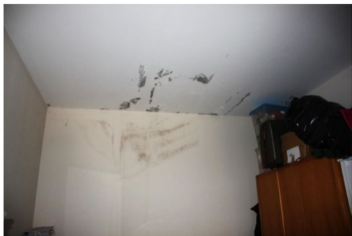
INDIVIDUAZIONE PORZIONI OGGETTO DI FENOMENI INFILTRATIVI
