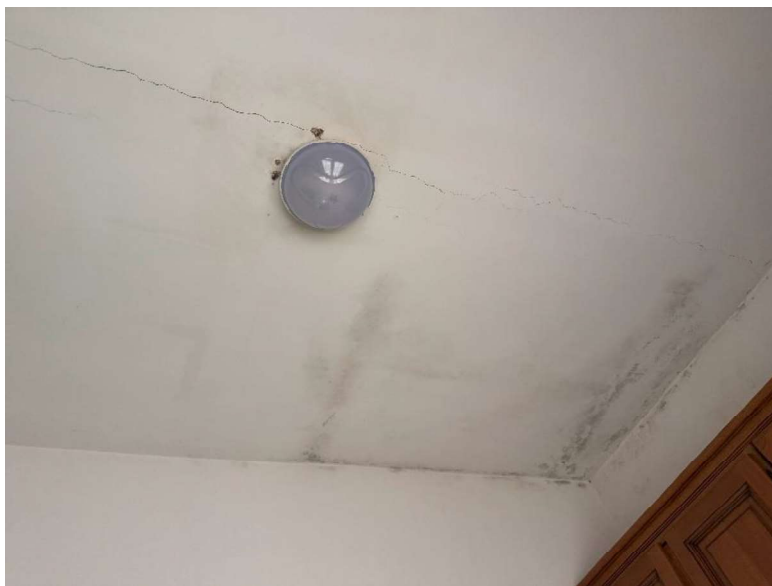
FOTO 13 FENOMENI DI CONDENZA
