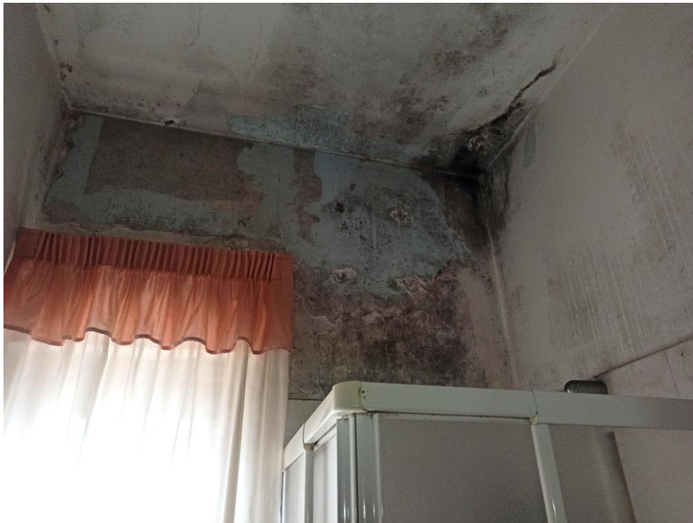
Foto n° 8 (interno abitazione – soffitto bagno 2)
