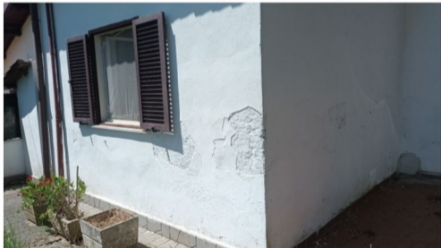
Foto n. 14 – Degrado intonaco esterno
