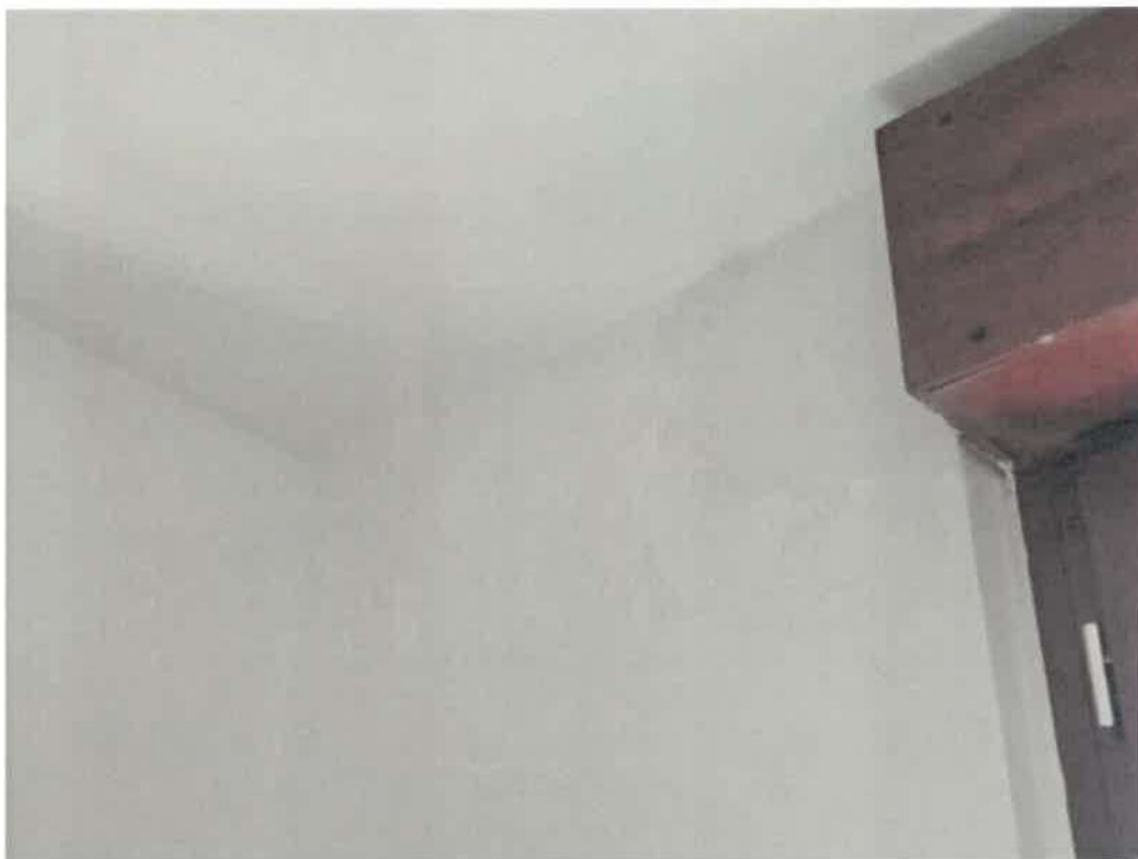
Dettaglio dell'infiltrazione riscontrata
