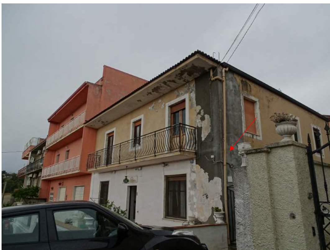
Foto 2 – Particolare immobile con evidenza dei fenomeni di infiltrazione
