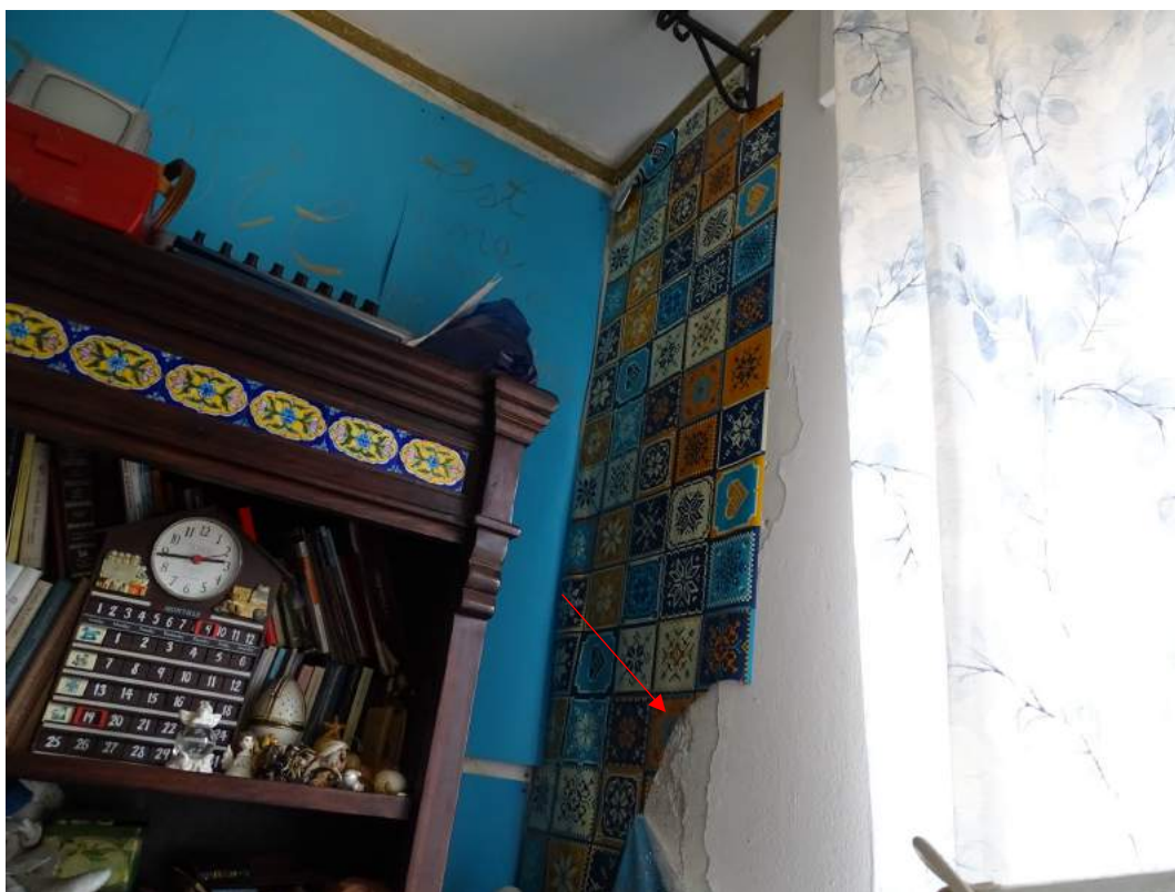
Foto 12 – Particolare della zona interessata da fenomeni di umidità localizzata nello Studio
