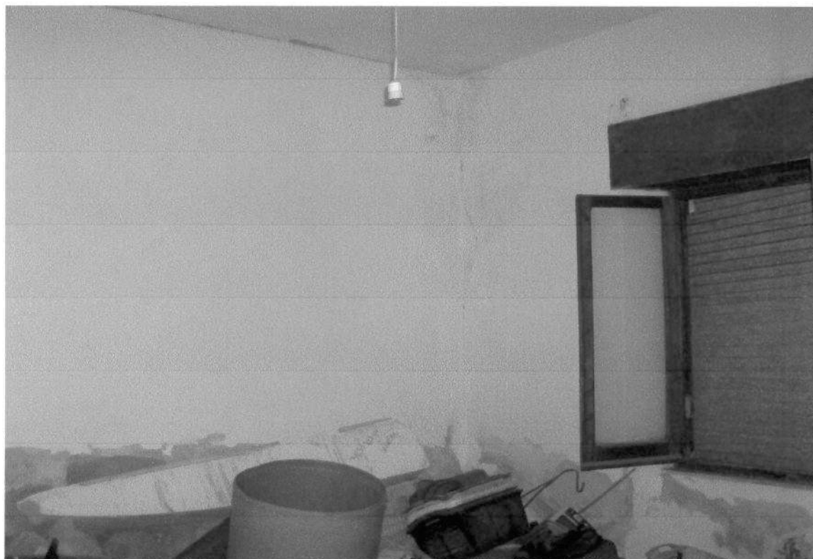
Stato di degrado degli intonaci e degli infissi
