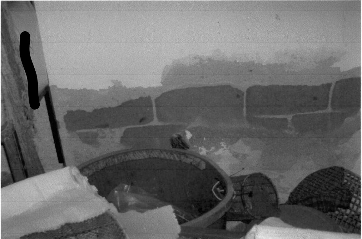
Depositi di rifiuti all'interno del locale
