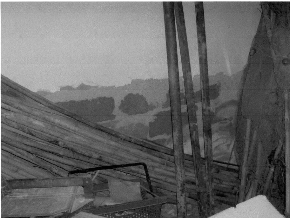
Scrostamenti negli intonaci
